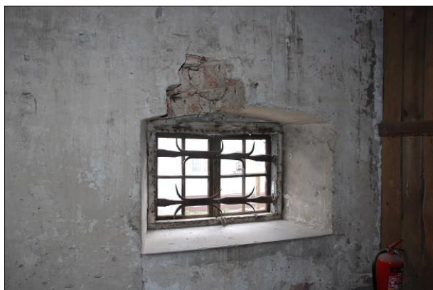
Fot. 39 Widoczne ubytki cegieł w nadprożu w ścianie zewnętrznej na piętrze.
