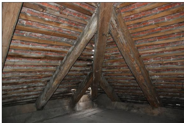
Fot. 79 Widoczna korozja krokwi.
