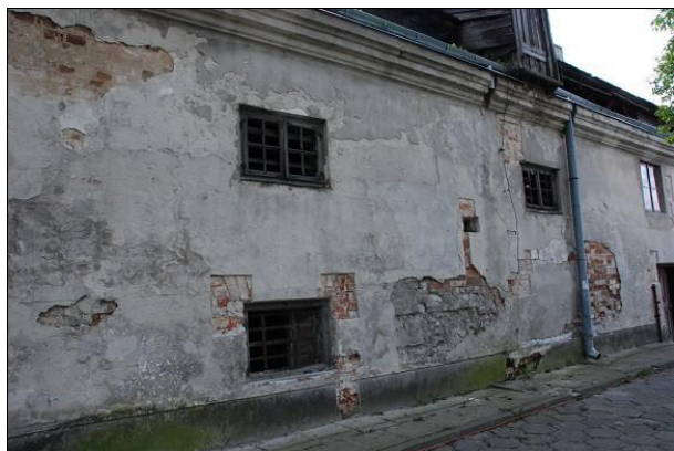
Fot. 37 Widoczne ubytki tynków i cegieł na elewacji północnej, spękania w rejonach otworów.
