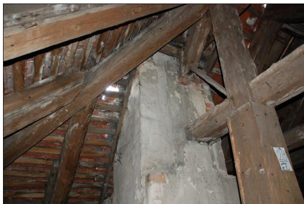
Fot. 97 Widoczna korozja krokwi. Ubytki pokrycia przy kominie.
