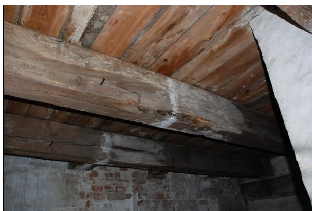
Fot. 71 Widoczna korozja belek w strefie środkowej.
