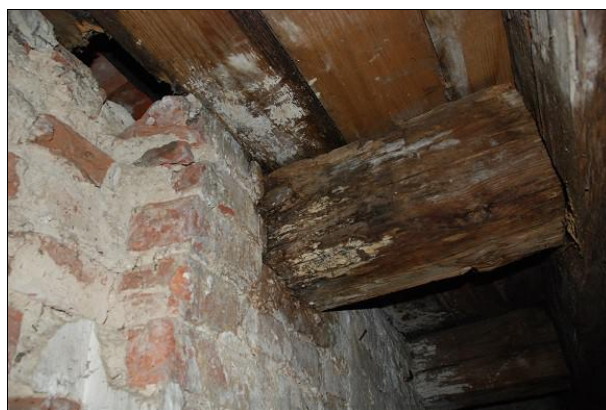
Fot. 72 Widoczna korozja belek w strefie podporowej.
