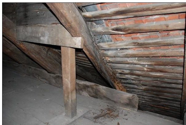
Fot. 100 Widoczna korozja krokwi w strefie zakończenia świetlika.
