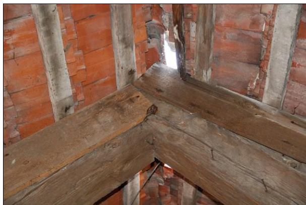
Fot. 103 Widoczne nadbitki w węźle kalenicowym. Ubytki pokrycia.
