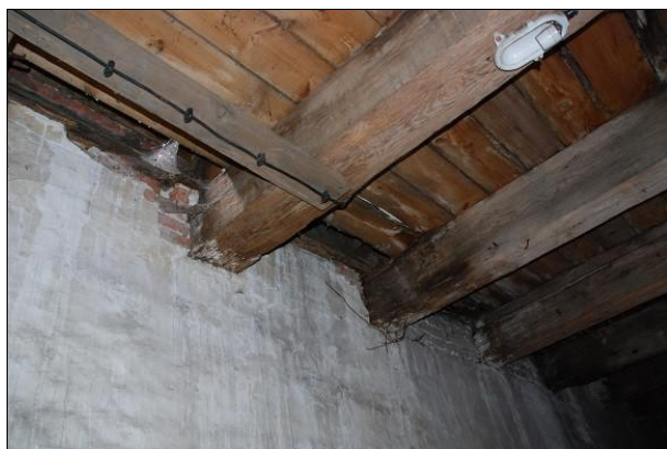
Fot. 69 Widoczna korozja belek w strefie podporowej.
