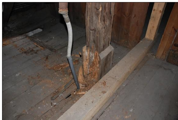
Fot. 84 Widoczna korozja podstawy słupa.
