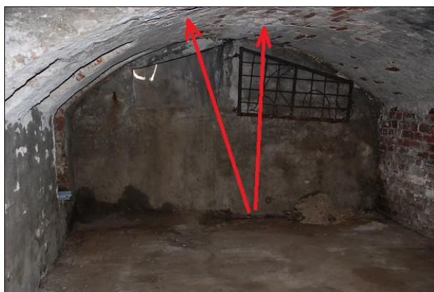
Fot. 45 Widoczna korozja sklepienia nad piwnicą wschodnią.
