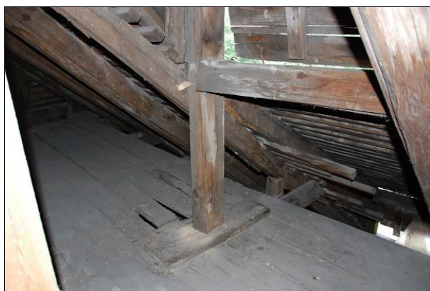
Fot. 101 Widoczna korozja krokwi w strefie zakończenia świetlika.
