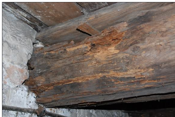
Fot. 74 Widoczna korozja belki w strefie podporowej.
