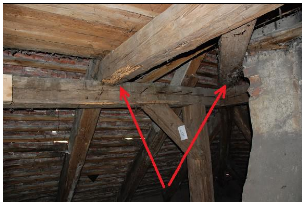
Fot. 83 Widoczna korozja belek poddasza przy kominie.
