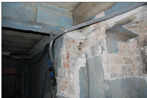
Fot. 57 Widoczny ubytek muru w oparciu drewnianego podciągu.
