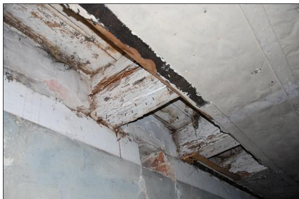
Fot. 53 Widoczna korozja belek stropu nad parterem przy ścianie zewnętrznej w części środkowej budynku.
