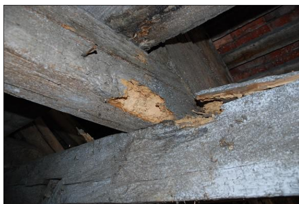
Fot. 94 Widoczna korozja belki poddasza.
