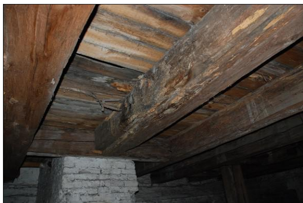
Fot. 75 Widoczna korozja belek przy kominie.
