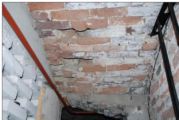
Fot. 50 Widoczne ubytki cegieł i spoin w sklepieniu nad piwnicą zachodnią.
