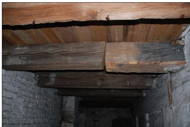
Fot. 73 Widoczny brak połączenia belek.
