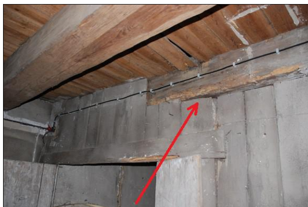
Fot. 63 Widoczna korozja belki stropowej nad piętrem.
