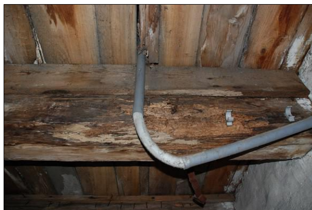
Fot. 70 Widoczna korozja belek w strefie środkowej.
