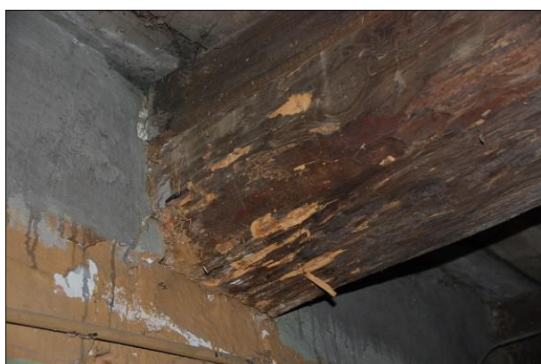
Fot. 65 Widoczna korozja belki w strefie podporowej.
