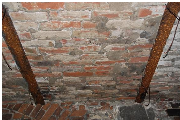
Fot. 43 Widoczna korozja belek stalowych stropu Kleina nad piwnicą wschodnią. Ubytki spoin płyty ceramicznej.
