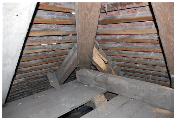
Fot. 96 Widoczna korozja krokwi.
