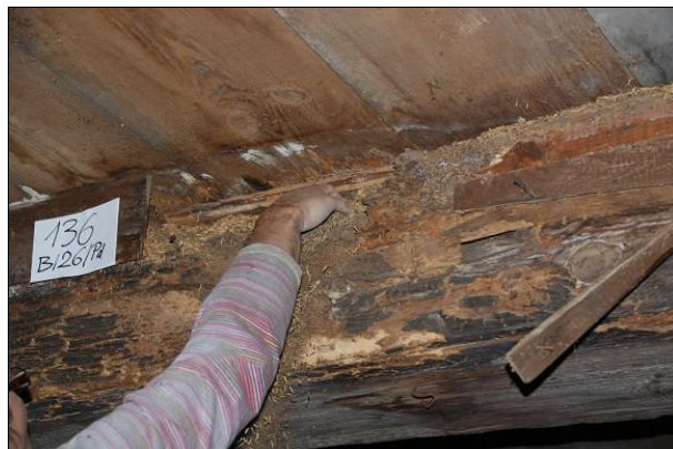
Fot. 62 Widoczne ziarna zbóż zamknięte w przypodłogowej strefie belek, utrzymujące wilgoć i potęgujące zjawisko korozji drewna.
