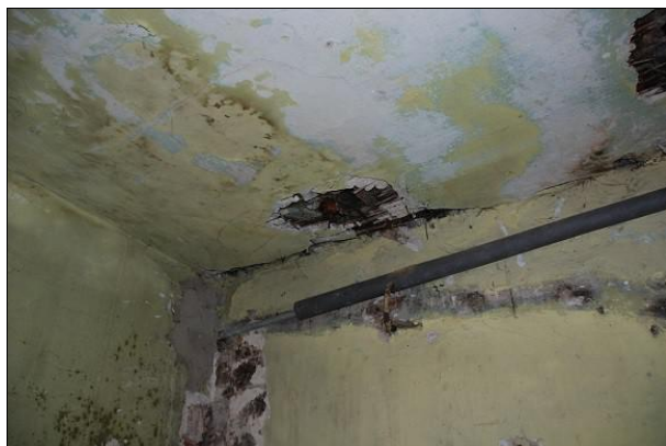
Fot. 59 Widoczne złuszczenia powłok malarskich, korozja biologiczna, spękania tynku na stropie, w części zachodniej.
