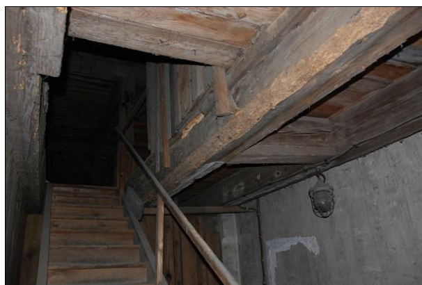
Fot. 78 Widoczna korozja belki.
