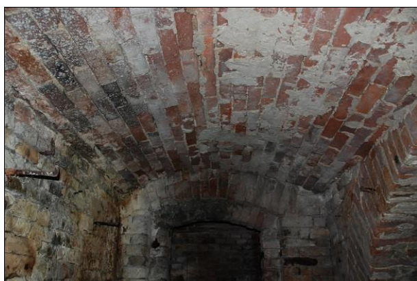
Fot. 47 Widoczna korozja sklepienia nad piwnicą zachodnią. Ubytki spoin.
