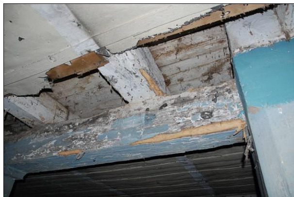
Fot. 54 Widoczna korozja belek stropu i podciągu nad parterem w części środkowej budynku.
