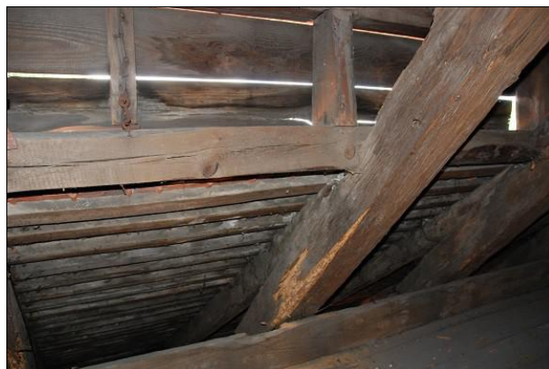
Fot. 98 Widoczna korozja krokwi w strefie świetlika.
