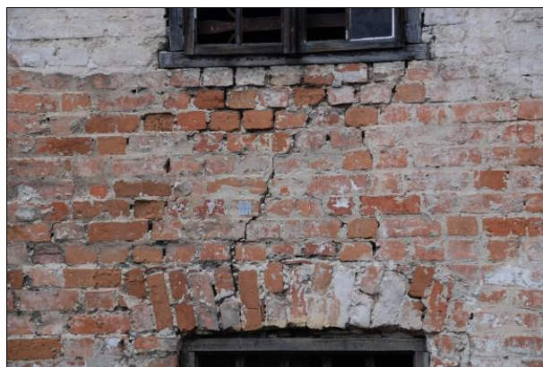
Fot. 34 Widok typowego spękania na elewacji południowej w rejonie nadproża.
