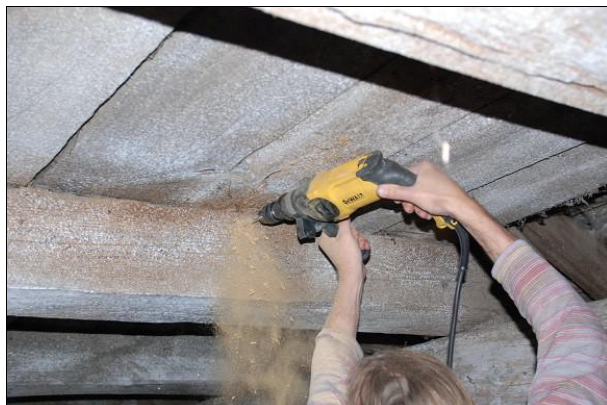
Fot. 61 Badanie stopnia korozji biologicznej przekroju drewnianego.
