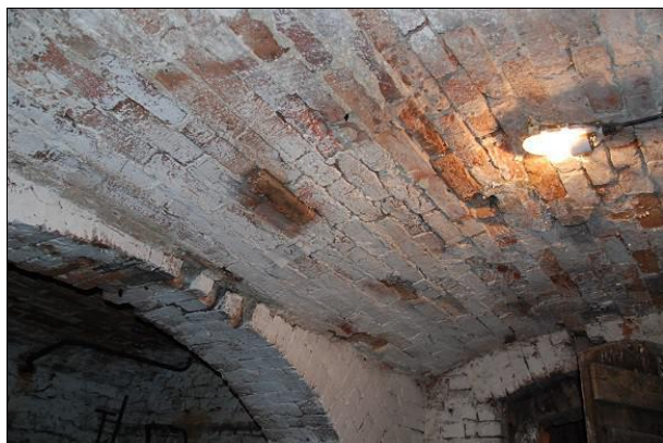
Fot. 49 Widoczna korozja sklepienia nad piwnicą zachodnią. Ubytki spoin.
