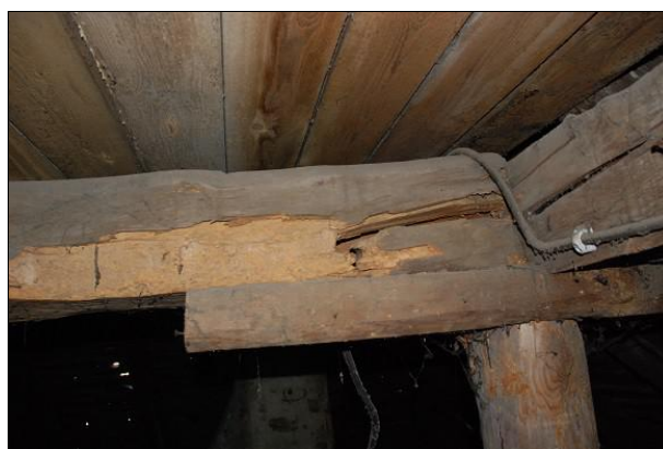
Fot. 82 Widoczna korozja belki poddasza oraz jej mechaniczne uszkodzenie.
