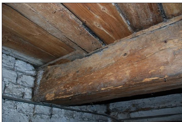
Fot. 77 Widoczna korozja belki.
