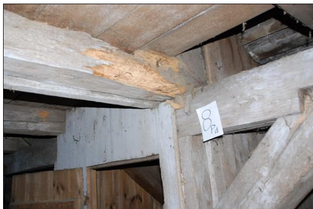
Fot. 91 Widoczna korozja belki poddasza.
