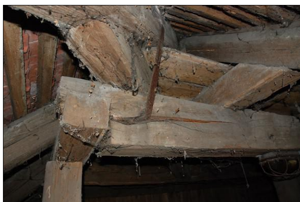
Fot. 81 Widoczne uszkodzenie płatwi.
