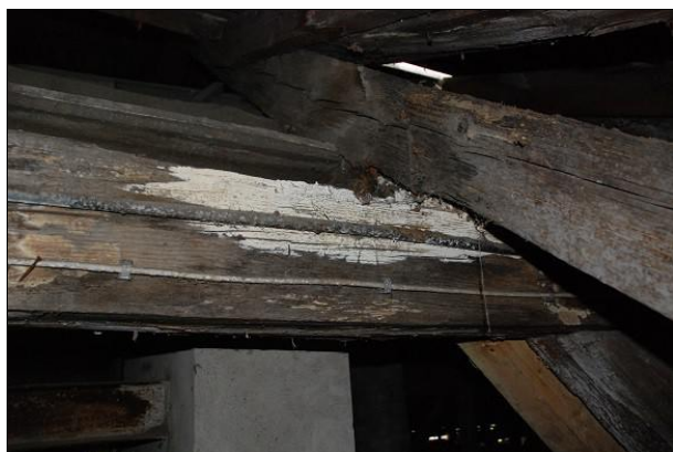
Fot. 87 Widoczna korozja płatwi.
