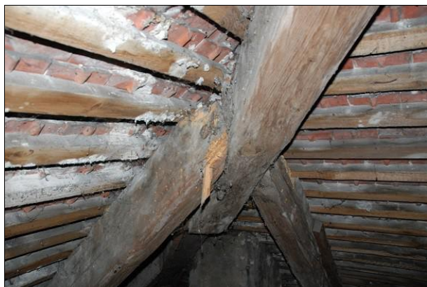
Fot. 95 Widoczna korozja krokwi. Połączenie krokwi narożnej.
