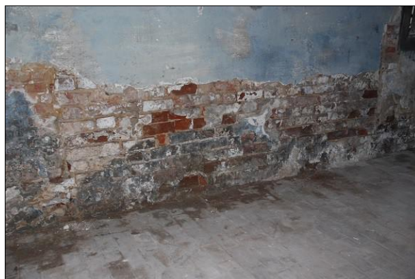
Fot. 40 Widoczne zawilgocenie ściany na parterze.
