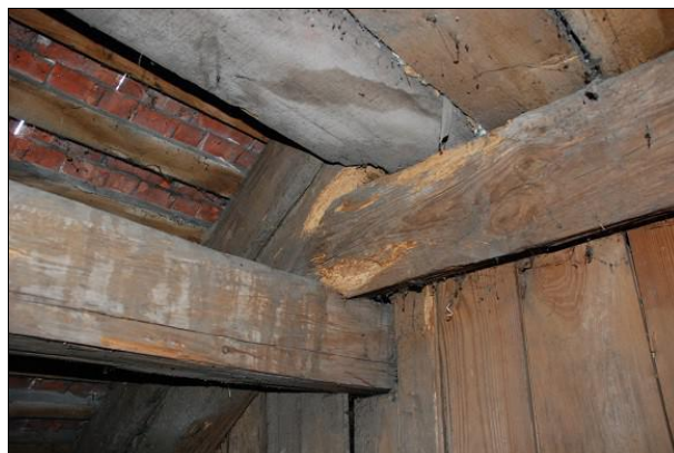
Fot. 80 Widoczna korozja belki poddasza.
