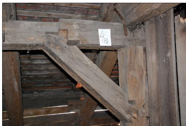
Fot. 90 Widoczne rozluźnienie węzła.
