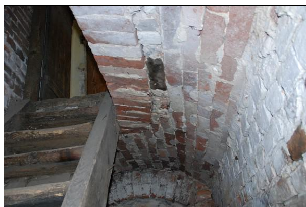
Fot. 48 Widoczne ubytki spoin w sklepieniu nad piwnicą zachodnią.
