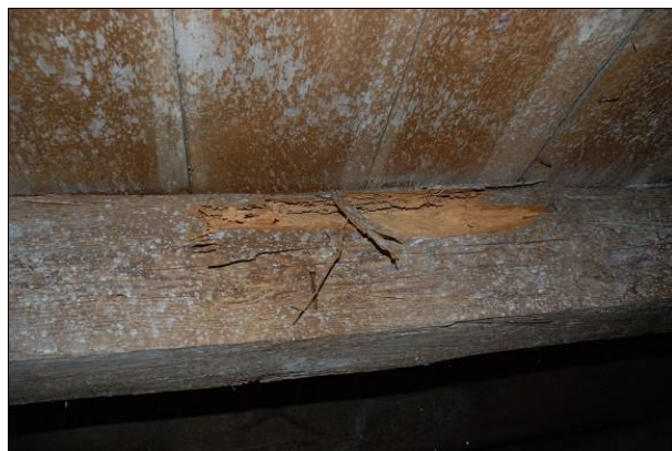
Fot. 92 Widoczna korozja belki poddasza.
