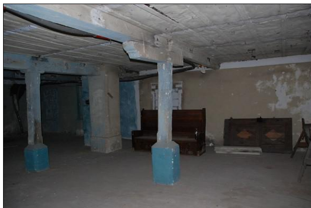
Fot. 55 Widoczne wychylenie słupa drewnianego z płaszczyzny pionowej. Ubytek wspornika, rozluźnienie węzła.
