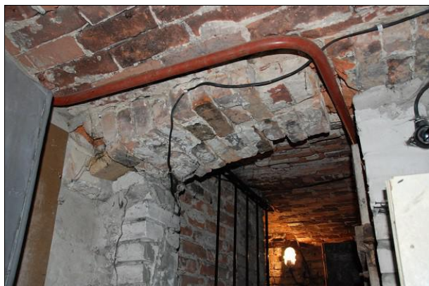
Fot. 41 Widoczne ubytki cegieł w nadprożu w ścianie wewnętrznej w piwnicy.
