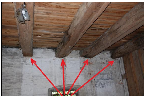
Fot. 67 Widoczna korozja belek w strefie podporowej.
