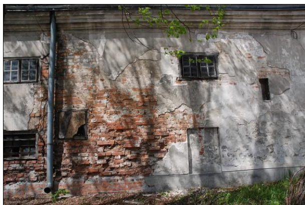
Fot. 33 Widoczne ubytki tynków i cegieł na elewacji zachodniej, spękania w rejonach otworów.
