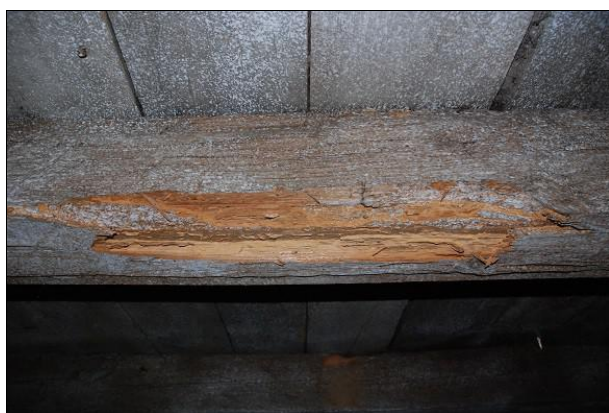
Fot. 93 Widoczna korozja belki poddasza.
