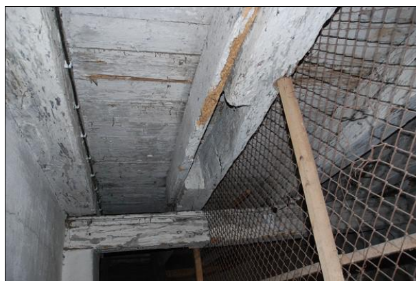
Fot. 52 Widoczne podcięcie belki stropowej nad parterem w części wschodniej.
