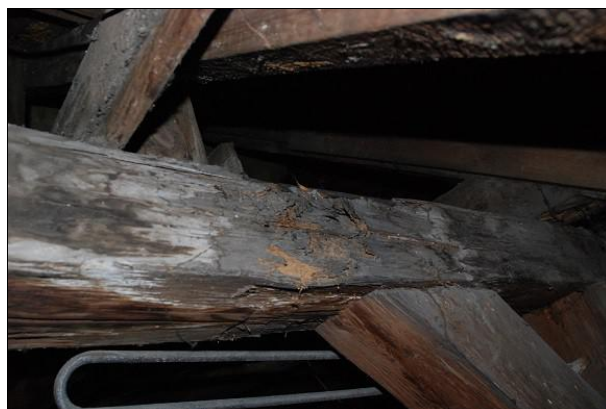
Fot. 88 Widoczna korozja płatwi.
