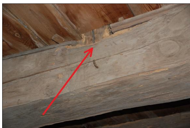
Fot. 66 Widoczna korozja biologiczna w miejscu oparcia słupka poddasza.
