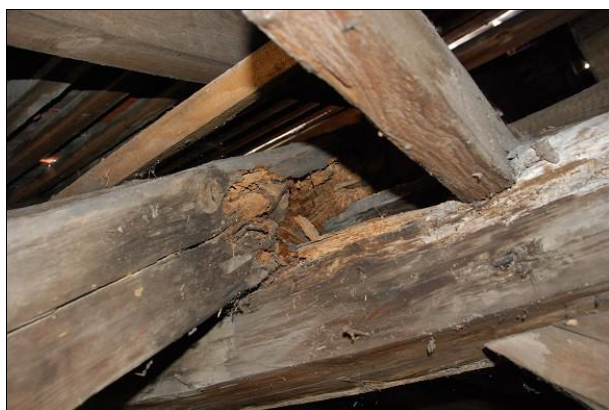
Fot. 89 Widoczna korozja krokwi i płatwi.
