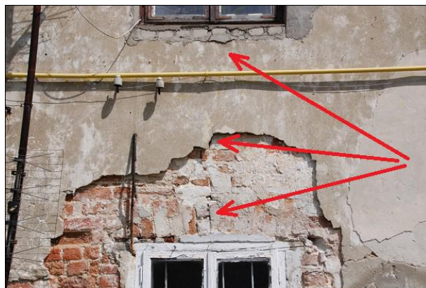
Fot. 32 Widok typowego spękania na elewacji zachodniej w rejonie nadproża.
