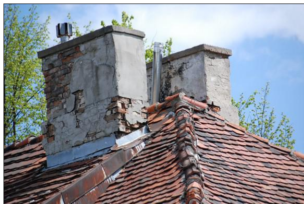
Fot. 42 Widoczne uszkodzenia kominów ponad dachem.
