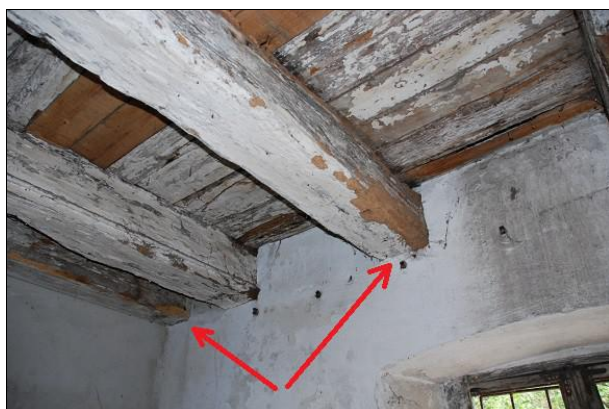
Fot. 51 Widoczna korozja belek stropu nad parterem w części wschodniej.
