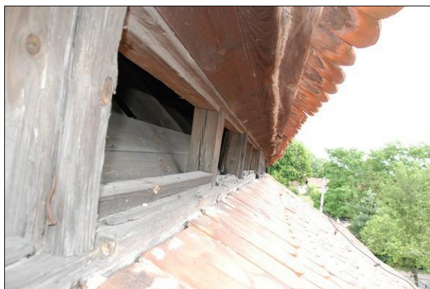
Fot. 99 Widok świetlika od zewnątrz. Brak obróbek blacharskich i uszczelnienia pokrycia.
