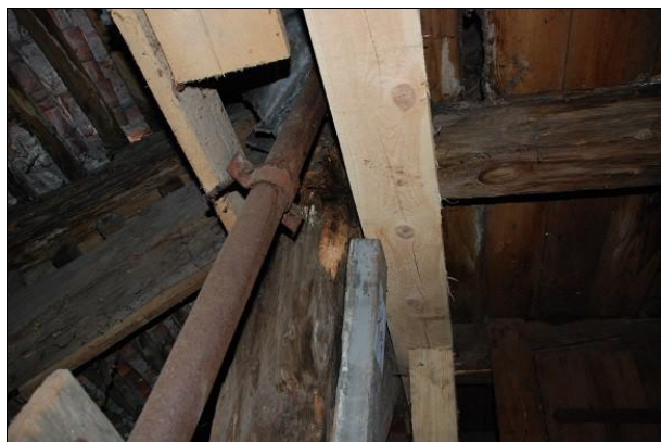
Fot. 85 Widoczna korozja płatwi oraz wzmocnienie więźby.
