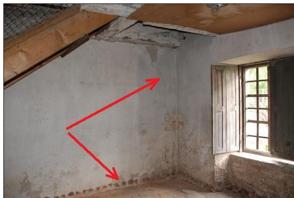
Fot. 38 Widok spekania na styku ściany zewnętrznej i wewnętrznej. Widoczne ślady po iniekcji p. wilgociowej.
