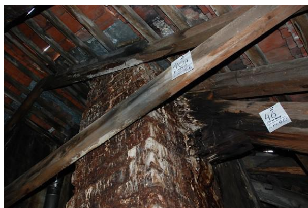
Fot. 102 Widoczne zacieki i korozja w rejonie komina.
