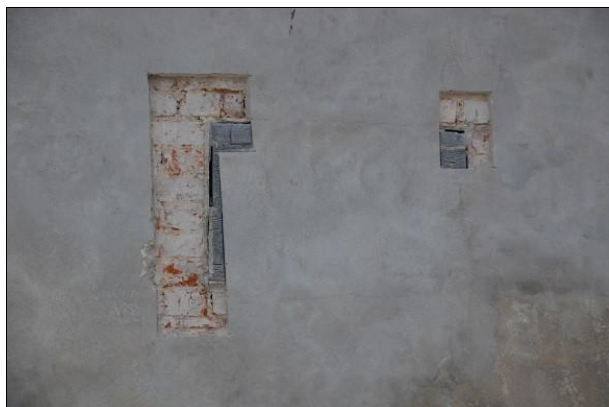
Fot. 35 Widoczne przemurowanie z gazobetonu na elewacji wschodniej.
