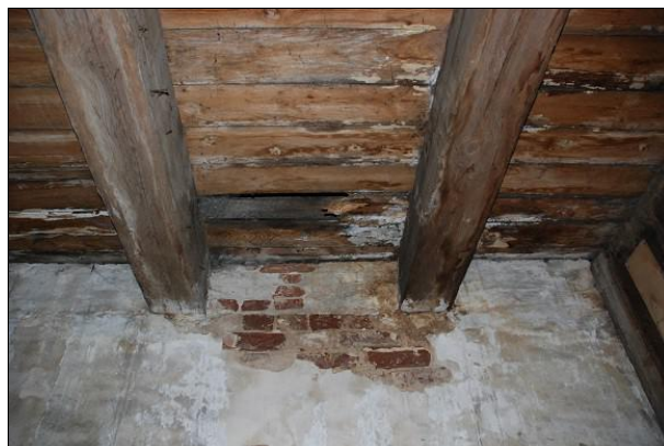
Fot. 68 Widoczna korozja belek w strefie podporowej.
