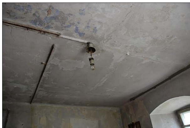
Fot. 58 Widoczne złuszczenia powłok malarskich, spękania tynku na stropie w części zachodniej.
