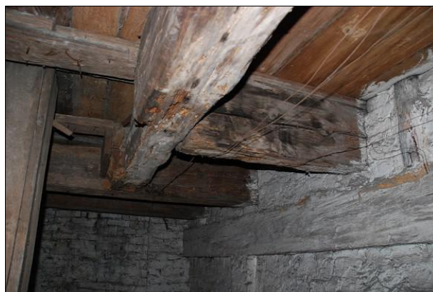
Fot. 76 Widoczna korozja wymianu przy kominie.
