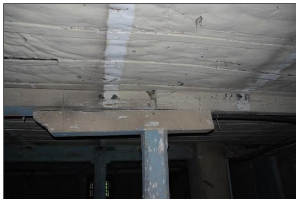
Fot. 56 Widoczny ubytek wspornika, rozluźnienie węzła.
