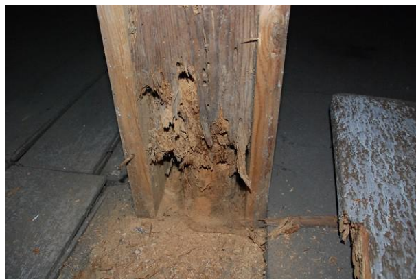
Fot. 86 Widoczna korozja podstawy słupa. Ubytek ponad 80% !
