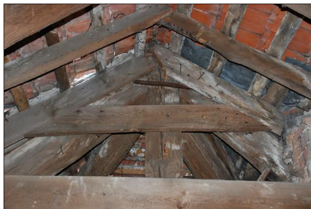
Fot. 104 Widoczne nadbitki w węźle kalenicowym. Ubytki pokrycia.
