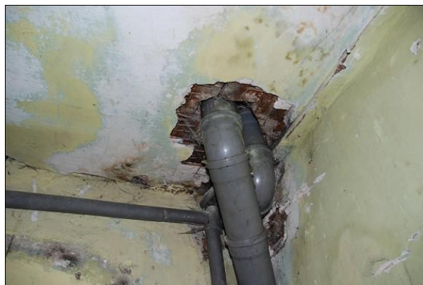
Fot. 60 Widoczne złuszczenia powłok malarskich, ubytki tynku na stropie w części zachodniej.
