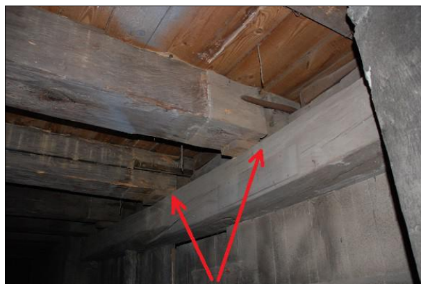
Fot. 64 Widoczne rozluźnienie węzłów środkowych.
