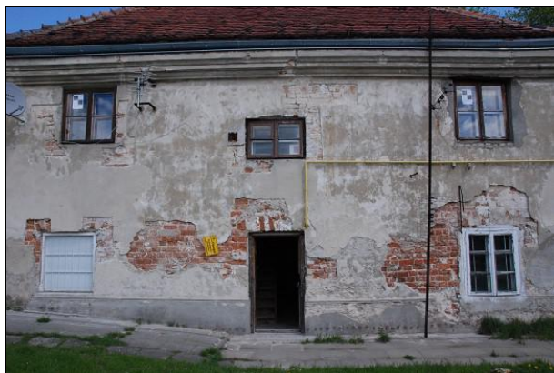
Fot. 31 Widoczne ubytki tynków na elewacji zachodniej, spękania w rejonach otworów.
