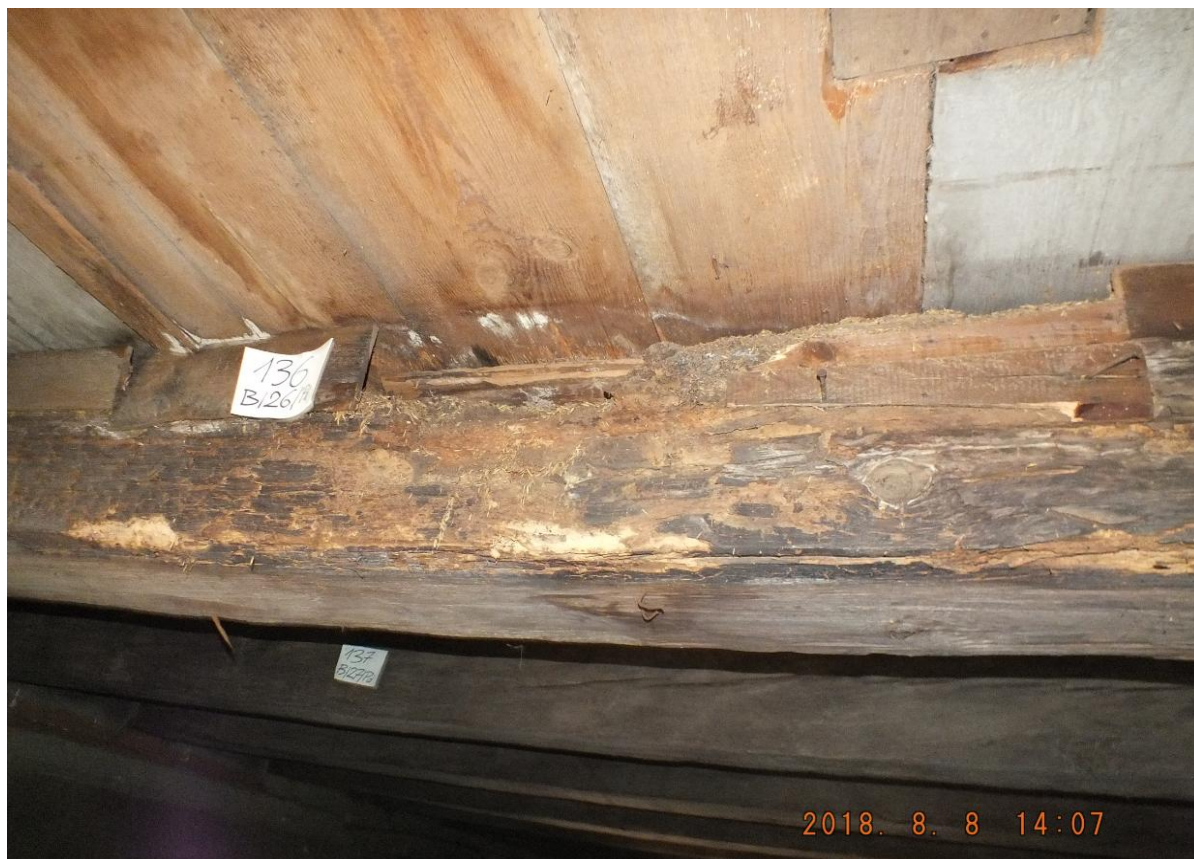
Fot. 27. Widok porażania biokorozyjnego oraz ubytków drewnianej belki stropu nad I piętrem
