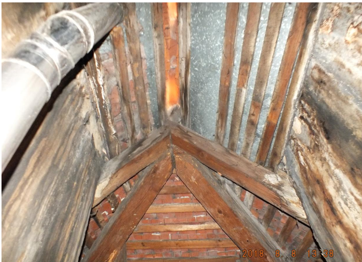
Fot. 14. Ilustracja porażen biokorozyjnych oraz stref zawilgoceń w obrębie zbiegu krokwi narożnych
