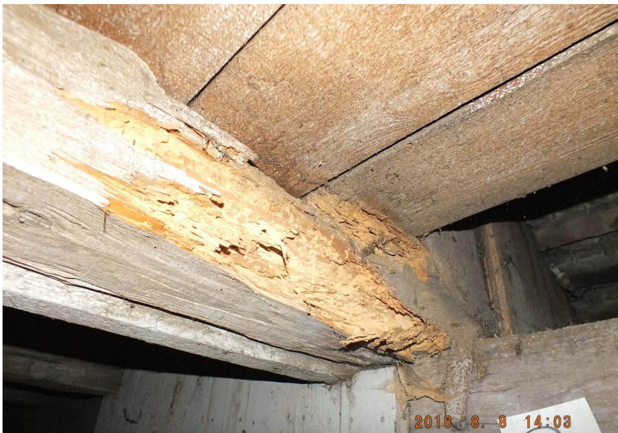
Fot. 19. Widok oparcia jętki drewnianej na płatwi osłabionej poprzez wynik żerowania spuszczela pospolitego
