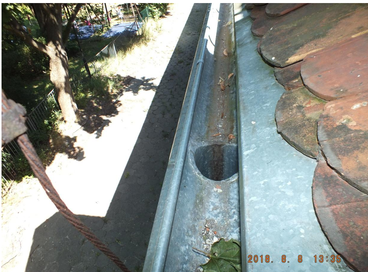
Fot. 11. Widok połączenia rynny oraz rury spustowej z lokalnymi oznakami korozji wodorotlenkowej
