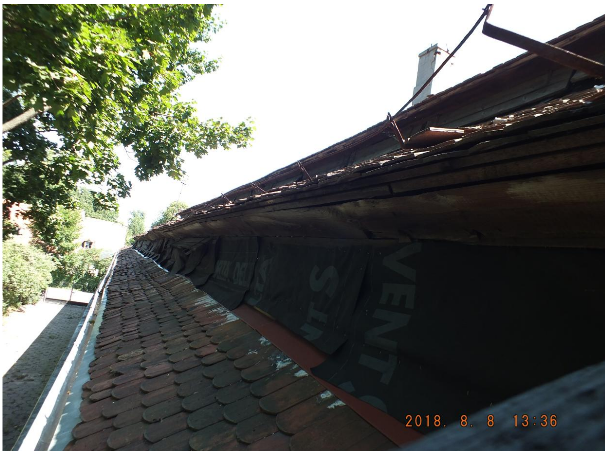
Fot. 10. Widok nadmiernej deformacji dachówek ceramicznych tworzących warstwę pokrycia dachowego
