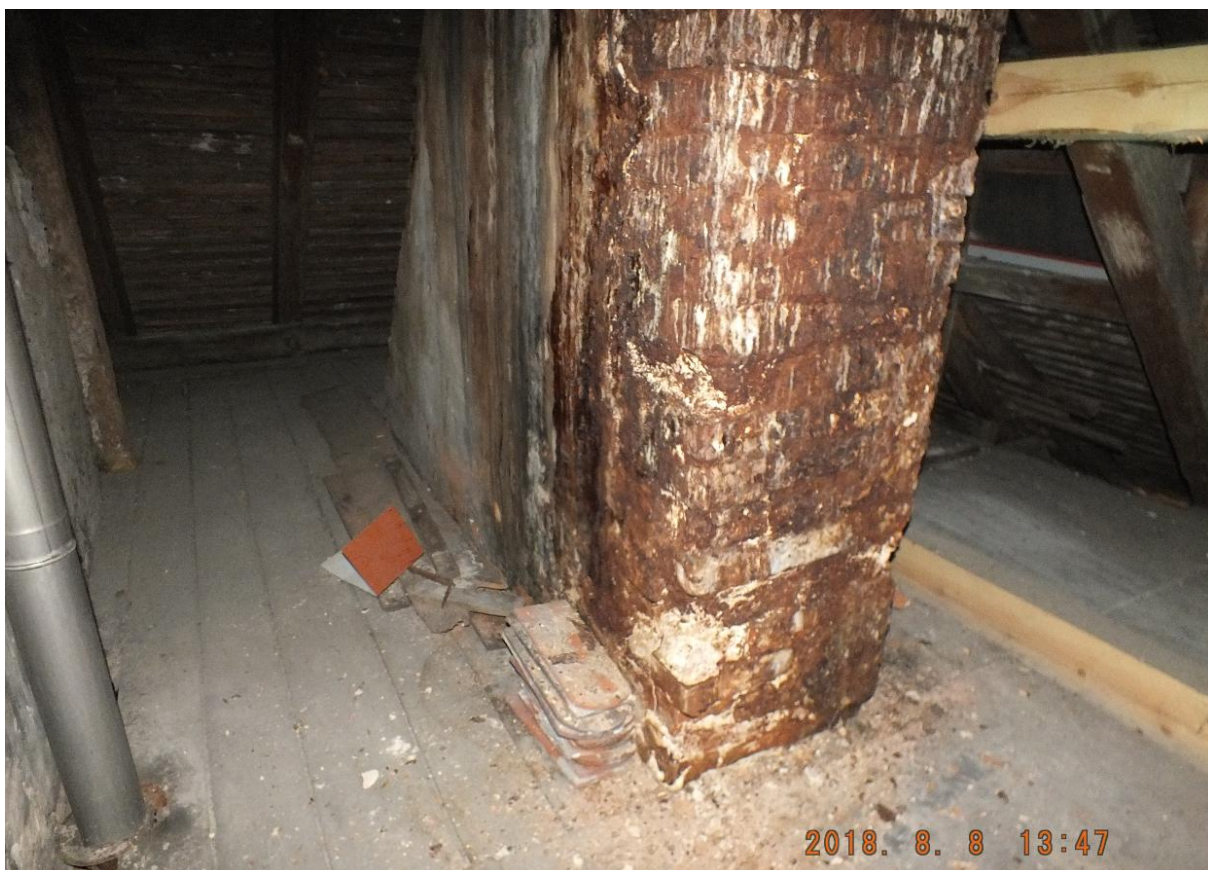
Fot. 22. Widok zabrudzeń murowanego filara zlokalizowanego w poziomie poddasza
