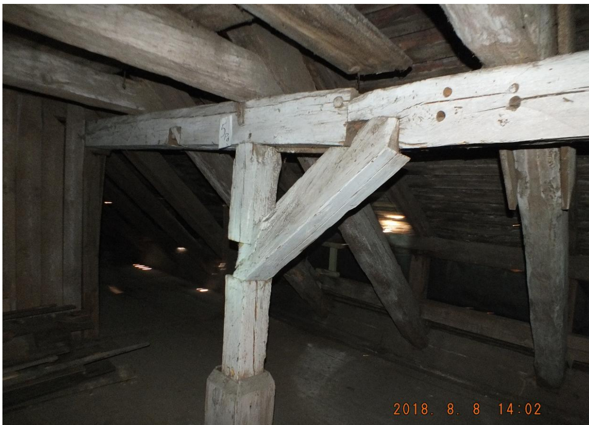
Fot. 17. Ubytki drewnianych mieczy wspierających podłużne płatwie
