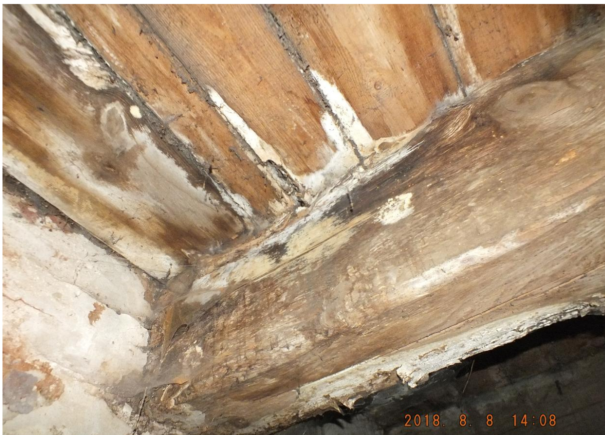
Fot. 25. Widok oparcia belki drewnianej stropu nad I piętrem na ścianie murowanej
