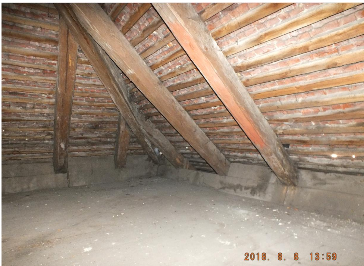
Fot. 15. Ilustracja zawilgoceń i porażen biokorozyjnych w obrębie narożnika budynku
