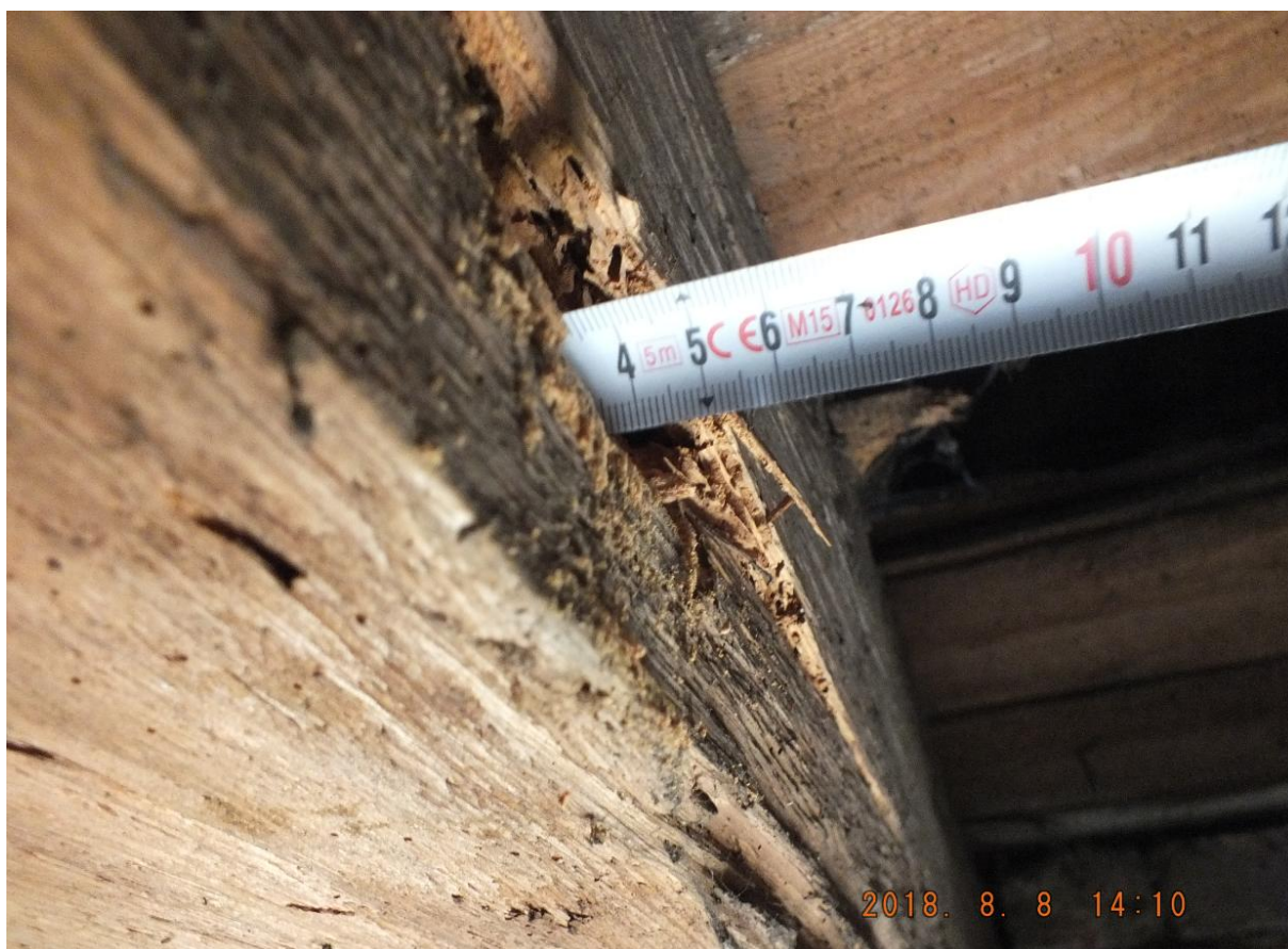
Fot. 26. Widok uszkodzenia belki stropowej w związku z żerowaniem drewnojadów
