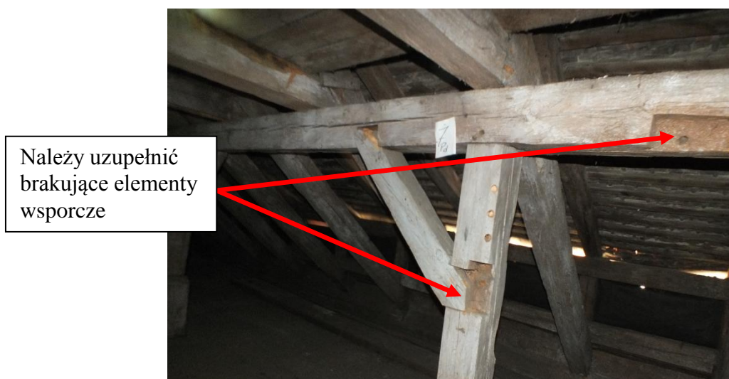
Fot. 4. Widok ubytku miecza drewnianego wspierającego płatw
