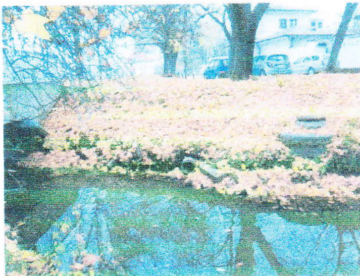
Wylot „D” nie obudowany, betonowy \varnothing 200 mm do Potoku Służewieckiego
