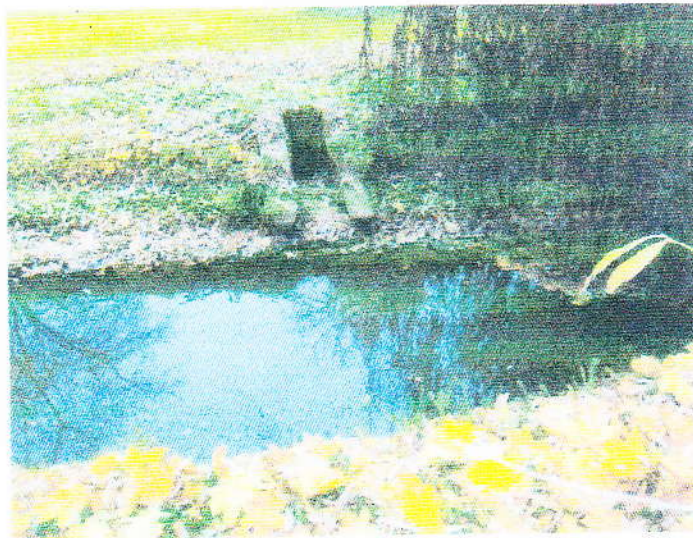
Wylot „C” obudowany, betonowy \varnothing 200 mm do Potoku Służewieckiego
