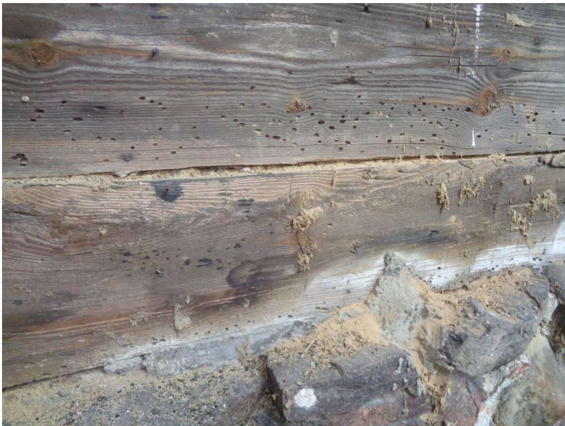
II.16. Budynek Gajówki w Parku Morysińskim, ocena stanu zachowania ścian obwodowych – ściana A, fragment ściany zasłonięty papą, kolonia wnyka amerykańskiego, fot. A. Maślak, sierpień 2023
