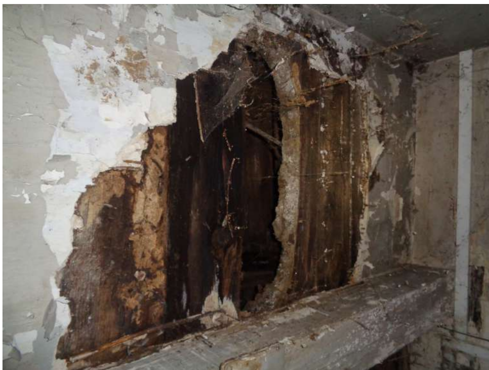
Il.36. Budynek Gajówki w Parku Morysińskim, ocena stanu zachowania stropu w pomieszczeniu kuchni, widoczny zły stan stropu, fot. A. Maślak, sierpień 2023
