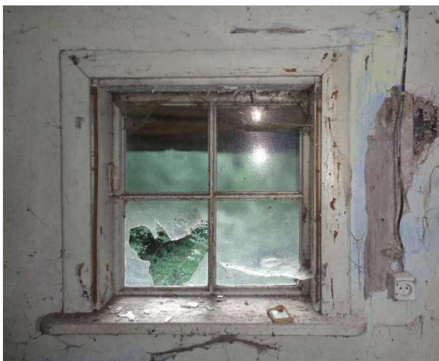
II.28. Budynek Gajówki w Parku Morysińskim, ocena stanu zachowania stolarki okiennej, okno w izbie na poddaszu, fot. A. Maślak, sierpień 2023
