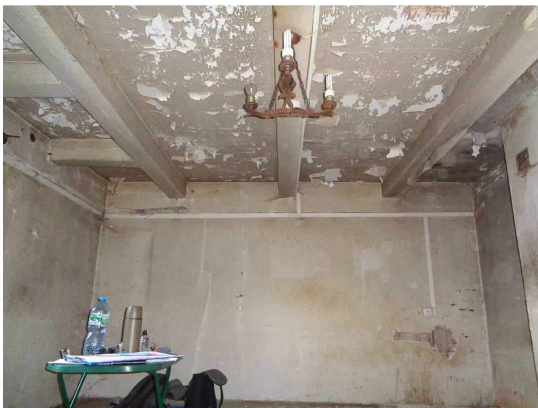
Il.38. Budynek Gajówki w Parku Morysińskim, ocena stanu zachowania stropu w pomieszczeniu izby, widoczna łuszcząca się farba ze stropu, fot. A. Maślak, sierpień 2023
