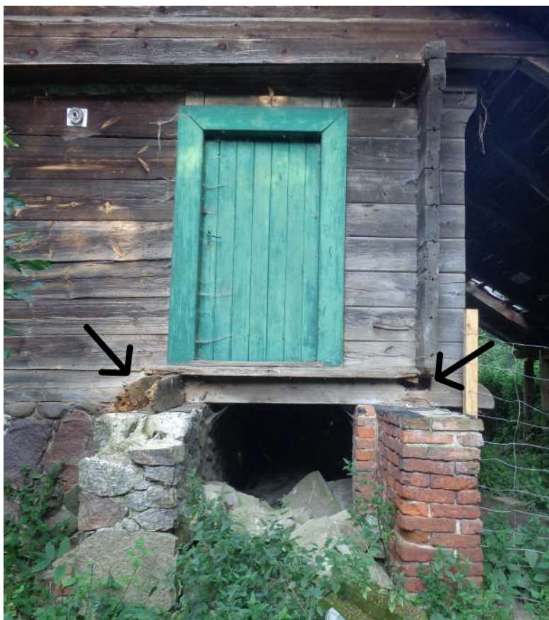
II.7. Budynek Gajówki w Parku Morysińskim, ocena stanu zachowania ścian obwodowych, widoczna destrukcja podwalin, strona północno-zachodnia, fot. A. Maślak, sierpień 2023
