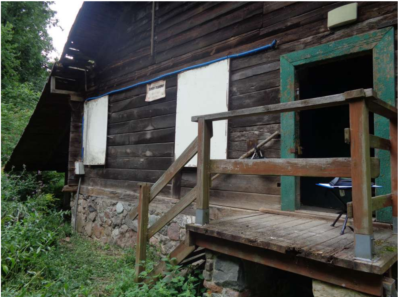
II.12. Budynek Gajówki w Parku Morysińskim, ocena stanu zachowania ścian obwodowych – ściana C, fot. A. Maślak, sierpień 2023
