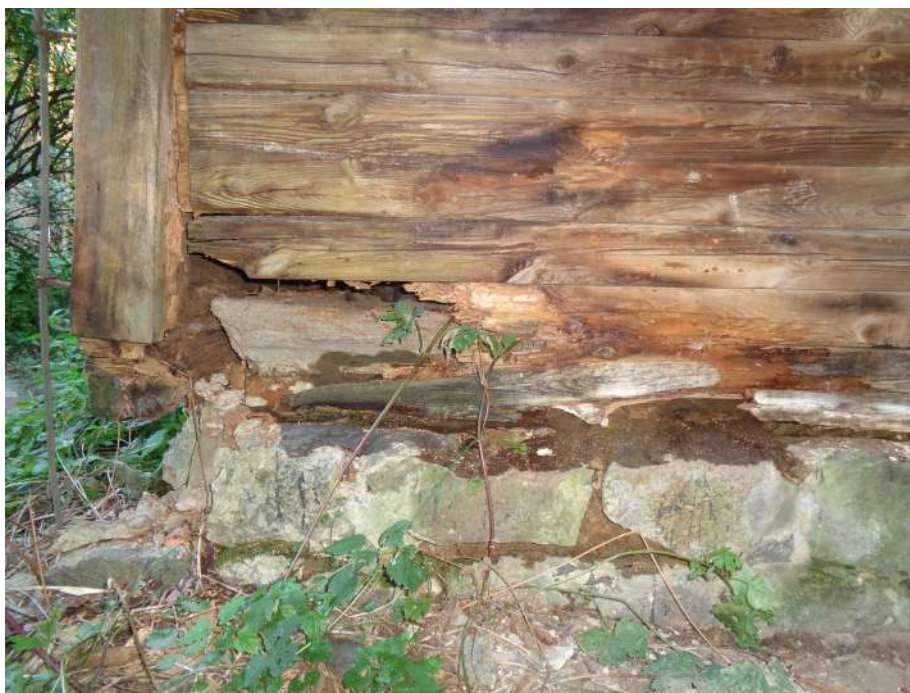
II.21. Budynek Gajówki w Parku Morysińskim, ocena stanu zachowania ścian obwodowych – ściana H, widok od zewnątrz, widoczne zawilgocenie, rozkład brunatny oraz wysunięcie elementów konstrukcyjnych ściany, fot. A. Maślak, sierpień 2023
