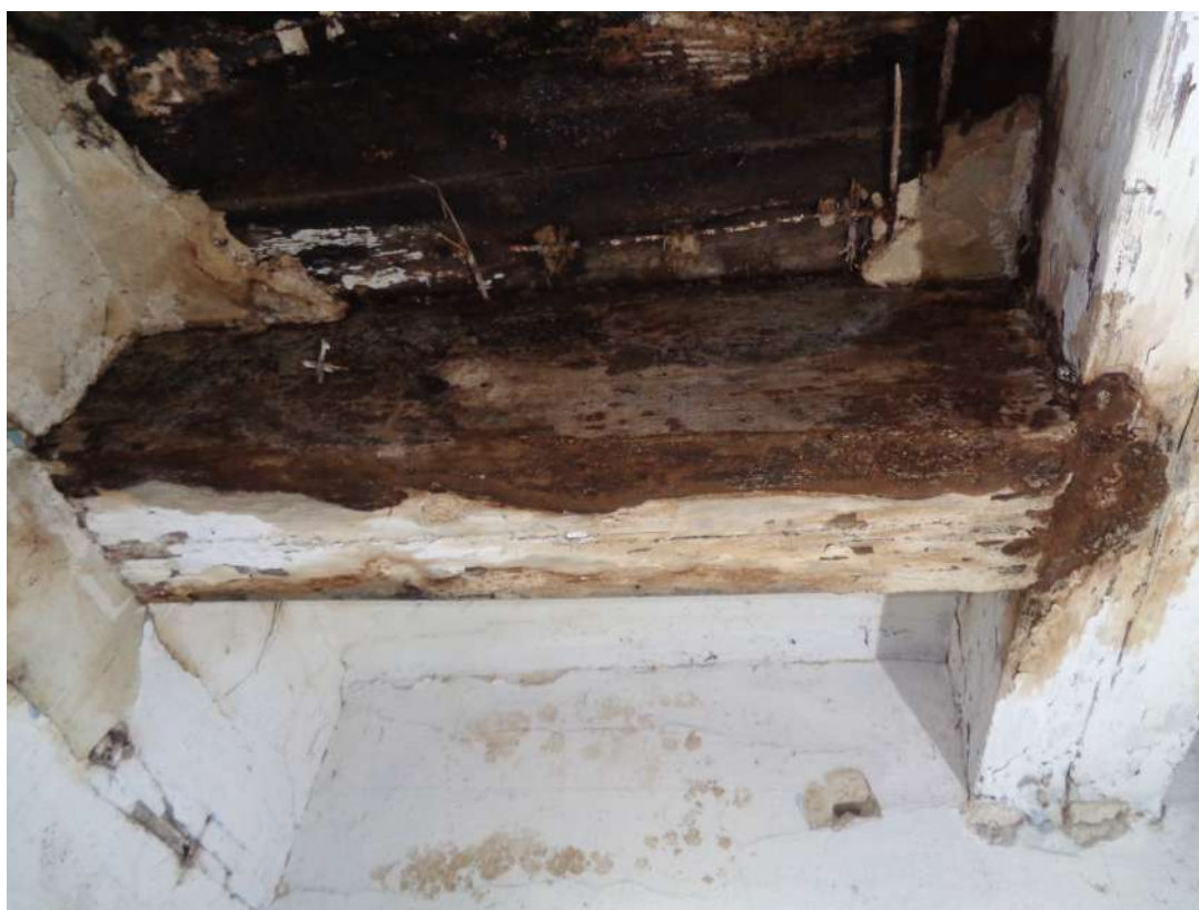
II.34. Budynek Gajówki w Parku Morysińskim, ocena stanu zachowania stropu w pomieszczeniu sieni, widoczny rozkład brunatny desek stropu i belki kulawkowej, fot. A. Maślak, sierpień 2023
