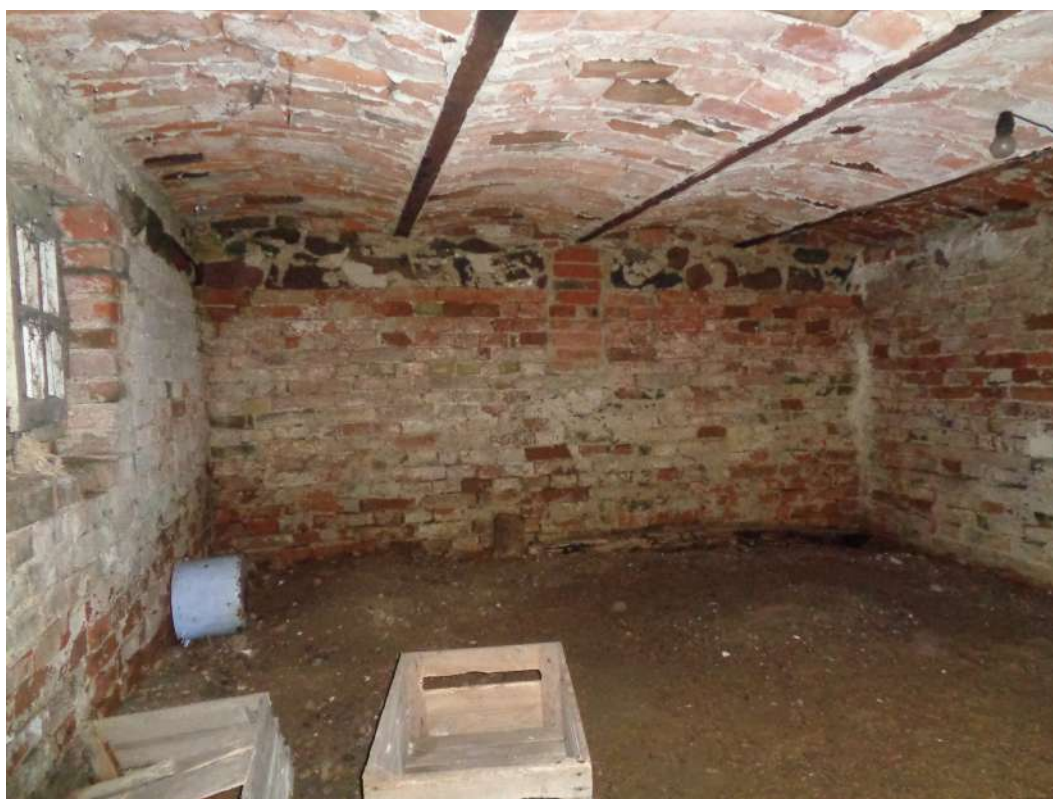
II.30. Budynek Gajówki w Parku Morysińskim, ocena stanu zachowania stropu piwnicy, fot. A. Maślak, sierpień 2023
