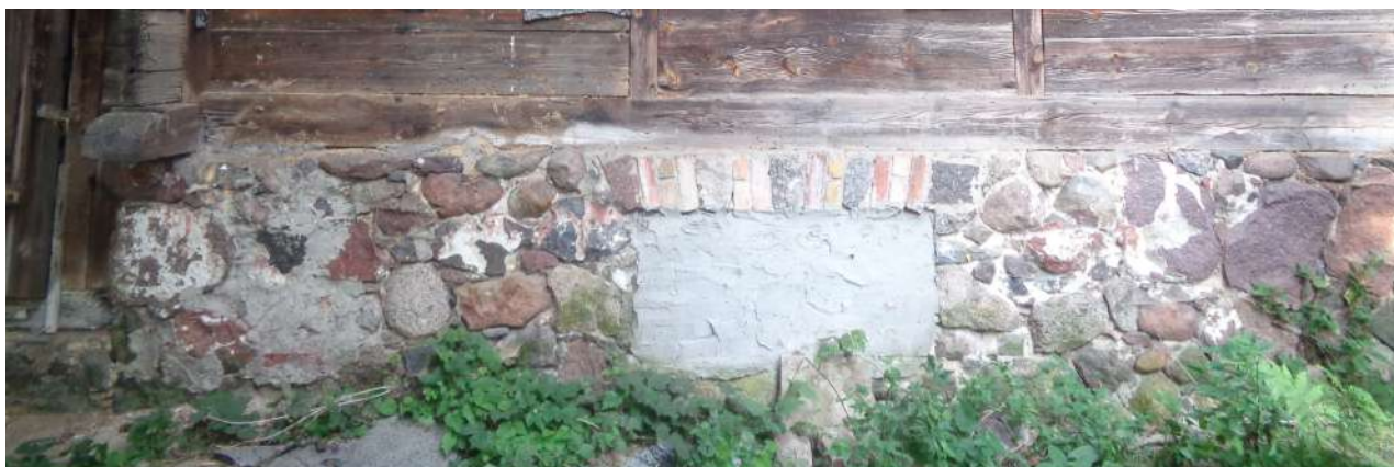
II. 1. Budynek Gajówki w Parku Morysińskim, ocena stanu zachowania fundamentu, widoczne uzupełnienia ubytków zaprawą cementową, ściana A, fot. A. Maślak, sierpień 2023
