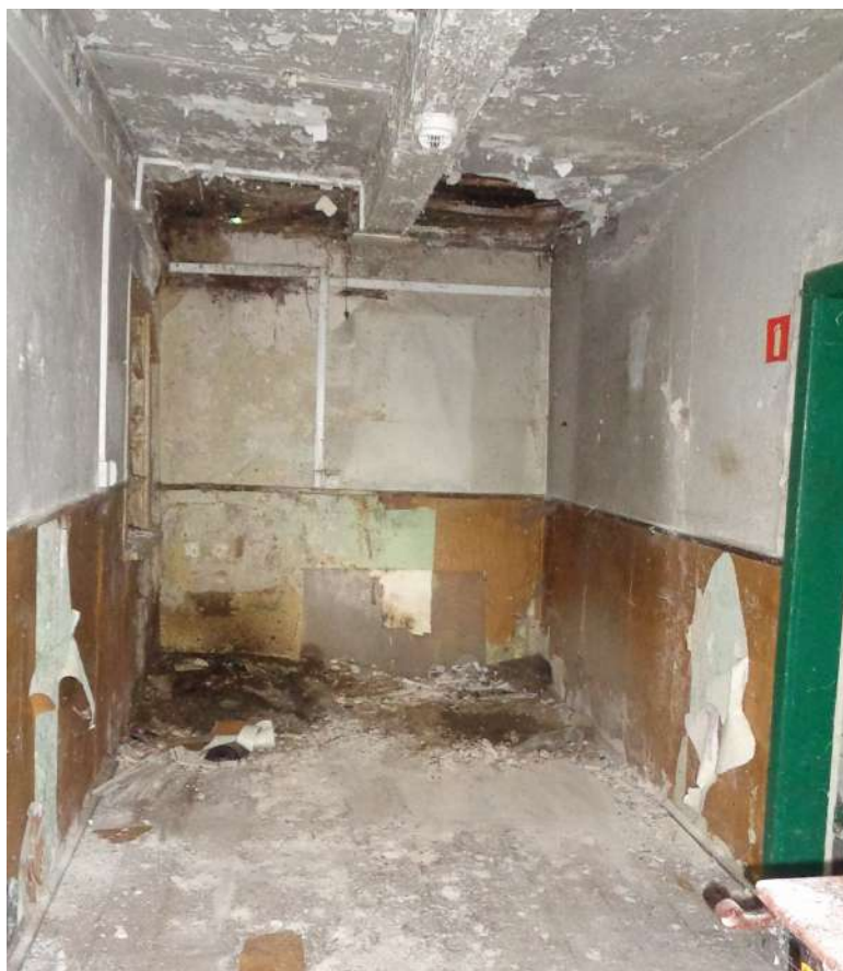
Il.35. Budynek Gajówki w Parku Morysińskim, ocena stanu zachowania stropu w pomieszczeniu kuchni, widoczny zły stan stropu, fot. A. Maślak, sierpień 2023
