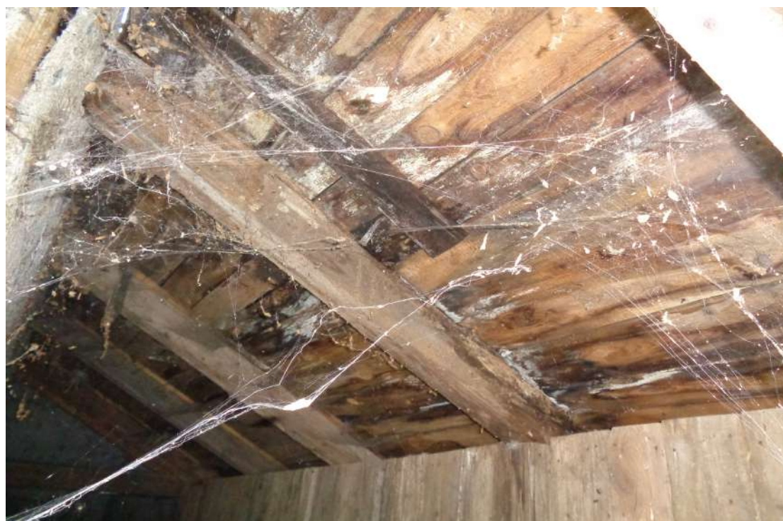
II.51. Budynek Gajówki w Parku Morysińskim, ocena stanu zachowania więźby dachowej, poddasze, widok na krokwie po stronie północno-wschodniej, fot. A. Maślak, sierpień 2023
