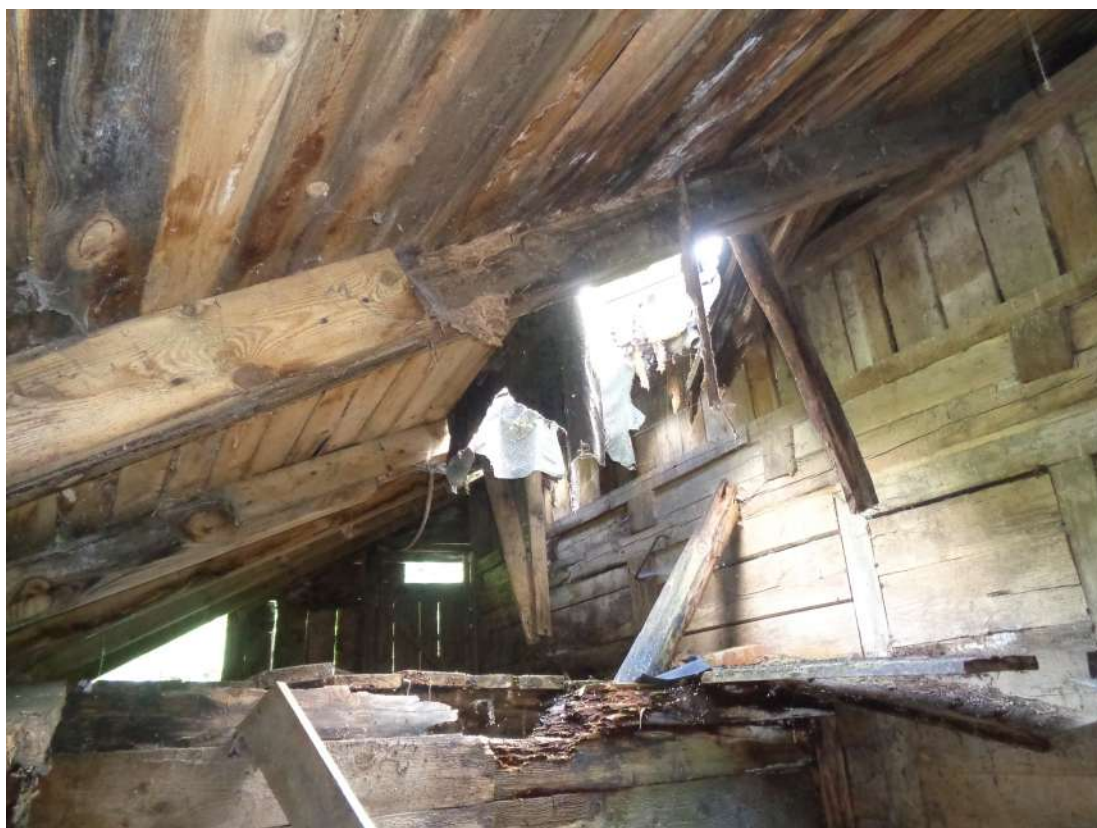
II.6. Budynek Gajówki w Parku Morysińskim, ocena stanu zachowania pokrycia dachowego, widoczne ubytki w pokryciu dachowym, strona północno-wschodnia, fot. A. Maślak, sierpień 2023
