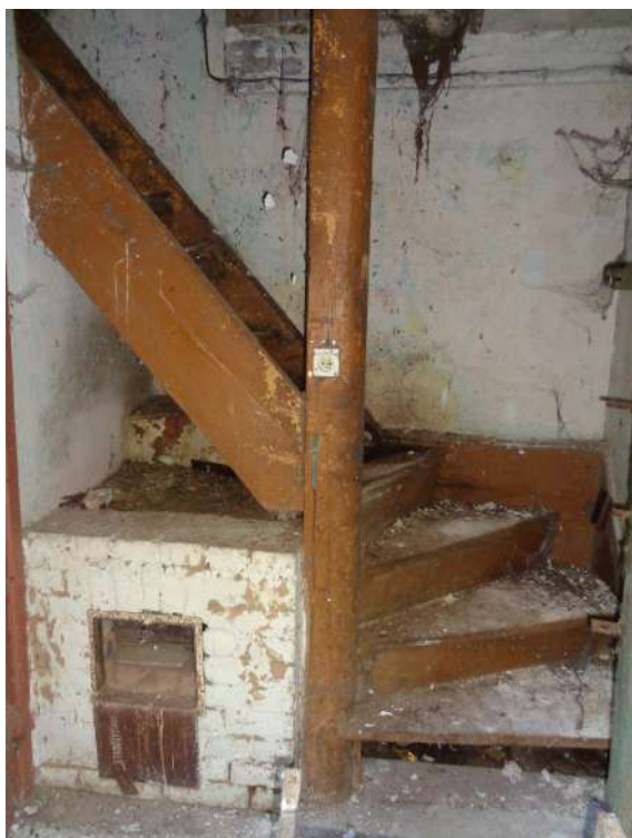
II.55. Budynek Gajówki w Parku Morysińskim, ocena stanu zachowania, schody wewnętrzne, fot. A. Maślak, sierpień 2023
