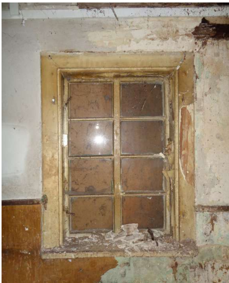
II.27. Budynek Gajówki w Parku Morysińskim, ocena stanu zachowania stolarki okiennej, okno w pomieszczeniu kuchni w przyziemiu, fot. A. Maślak, sierpień 2023
