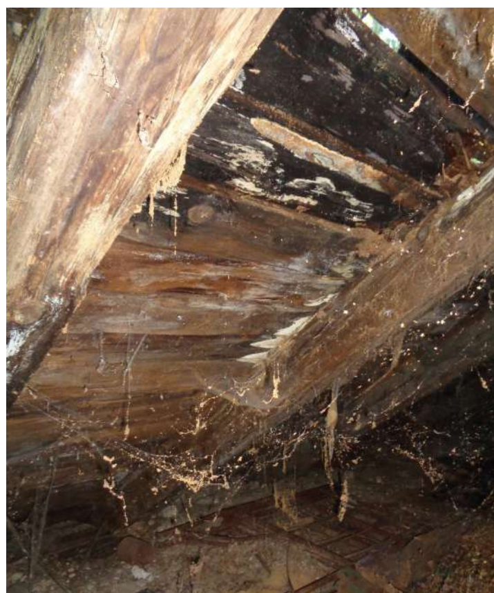
II.49. Budynek Gajówki w Parku Morysińskim, ocena stanu zachowania więźby dachowej, poddasze, widok na krokwie po stronie południowo-zachodniej, fot. A. Maślak, sierpień 2023
