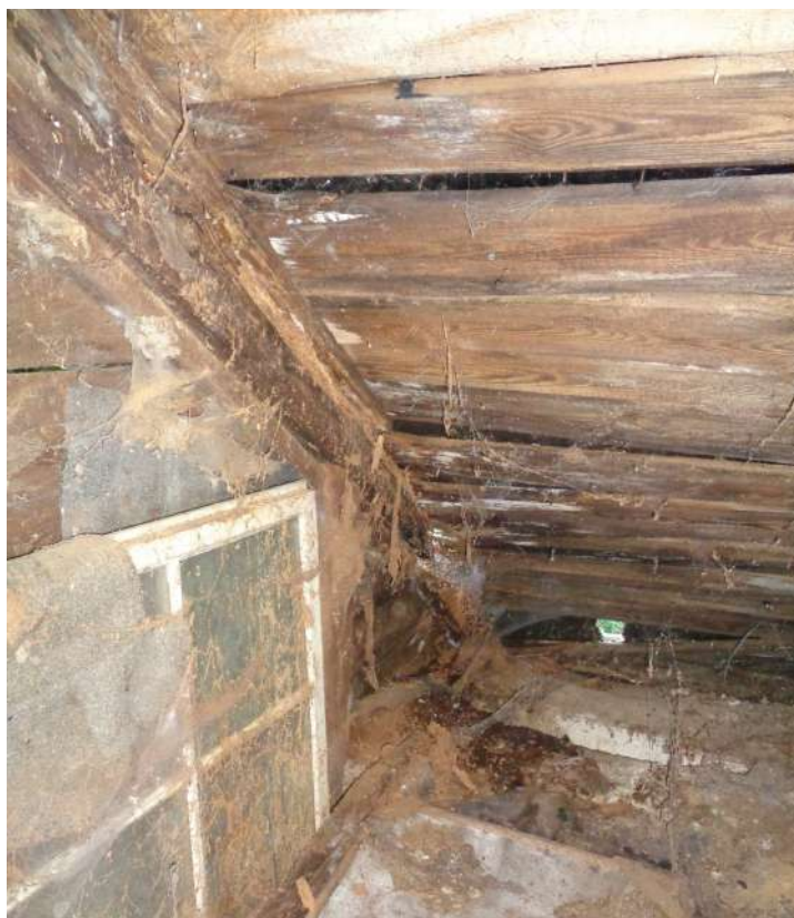
II.48. Budynek Gajówki w Parku Morysińskim, ocena stanu zachowania więźby dachowej, poddasze, widok na krokwie po stronie południowo-zachodniej, fot. A. Maślak, sierpień 2023
