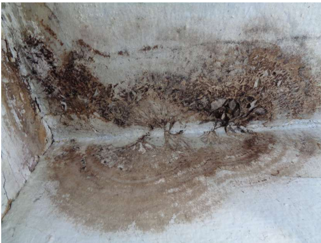
II.33. Budynek Gajówki w Parku Morysińskim, ocena stanu zachowania stropu w pomieszczeniu sieni, grzybnia i sznury grzyba domowego białego, fot. A. Maślak, sierpień 2023
