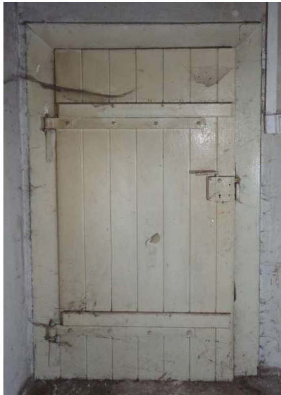
II.57. Budynek Gajówki w Parku Morysińskim, ocena stanu zachowania, drzwi wewnętrzne, fot. A. Maślak, sierpień 2023
