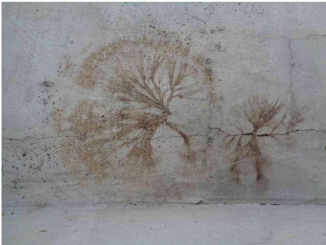
II.32. Budynek Gajówki w Parku Morysińskim, ocena stanu zachowania stropu w pomieszczeniu sieni, grzybnia i sznury grzyba domowego białego, fot. A. Maślak, sierpień 2023
