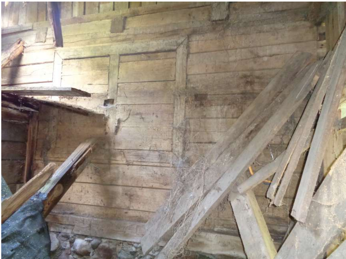
II.14. Budynek Gajówki w Parku Morysińskim, ocena stanu zachowania ścian obwodowych – ściana B, fot. A. Maślak, sierpień 2023
