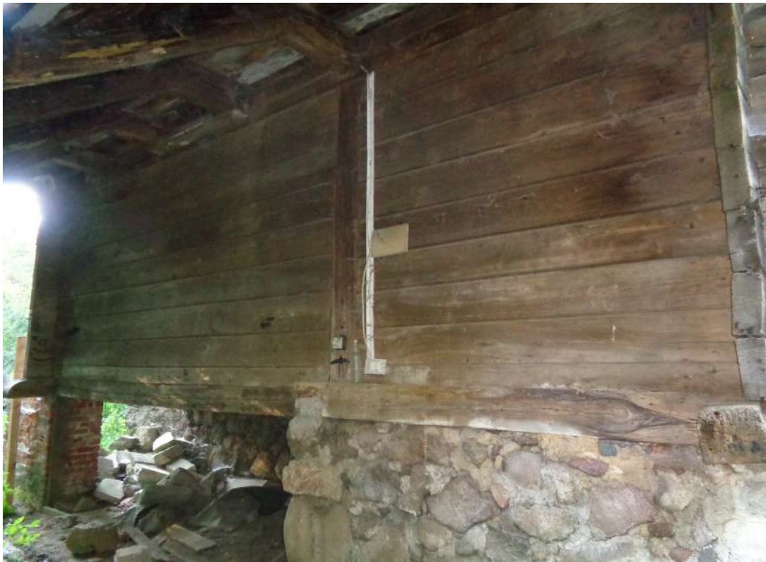
II.13. Budynek Gajówki w Parku Morysińskim, ocena stanu zachowania ścian obwodowych – ściana D, fot. A. Maślak, sierpień 2023
