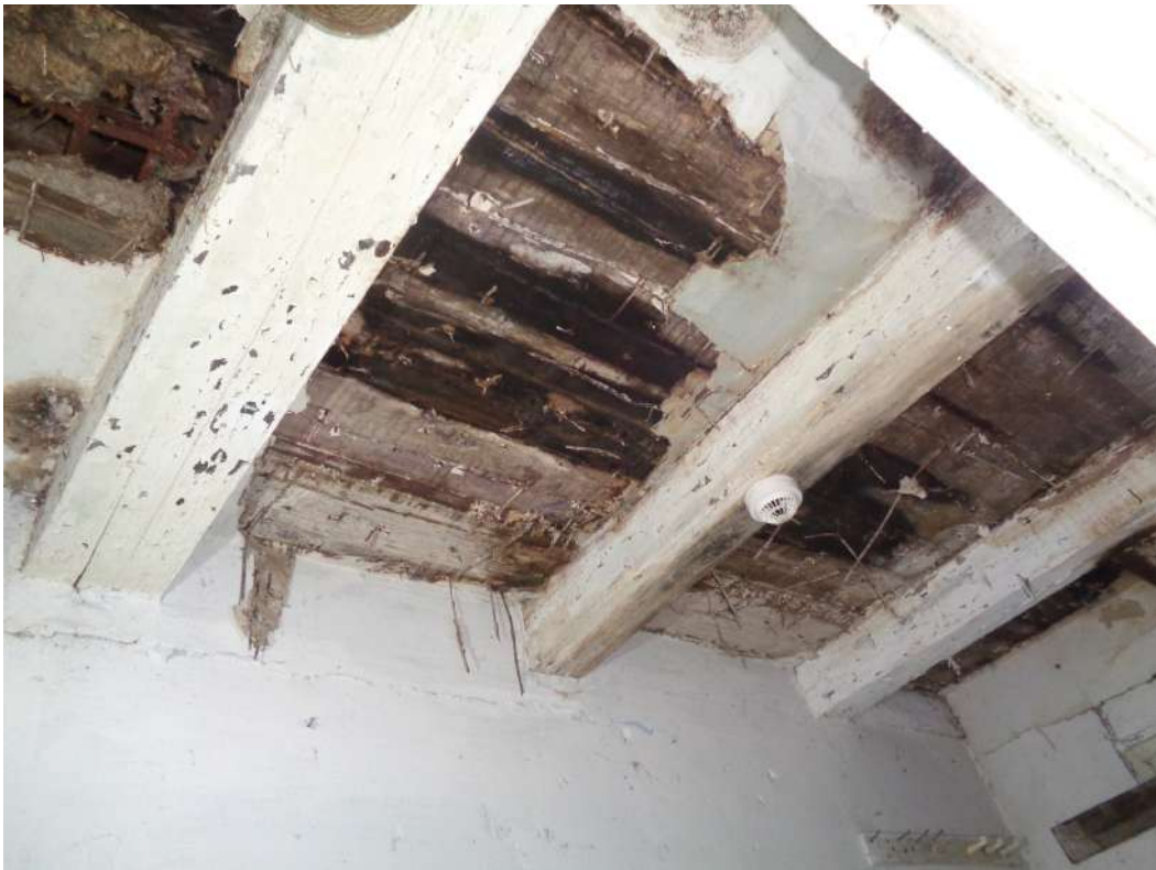
II.31. Budynek Gajówki w Parku Morysińskim, ocena stanu zachowania stropu w pomieszczeniu sieni, widoczne odspojenie tynku oraz zawilgocenie desek stropu, fot. A. Maślak, sierpień 2023
