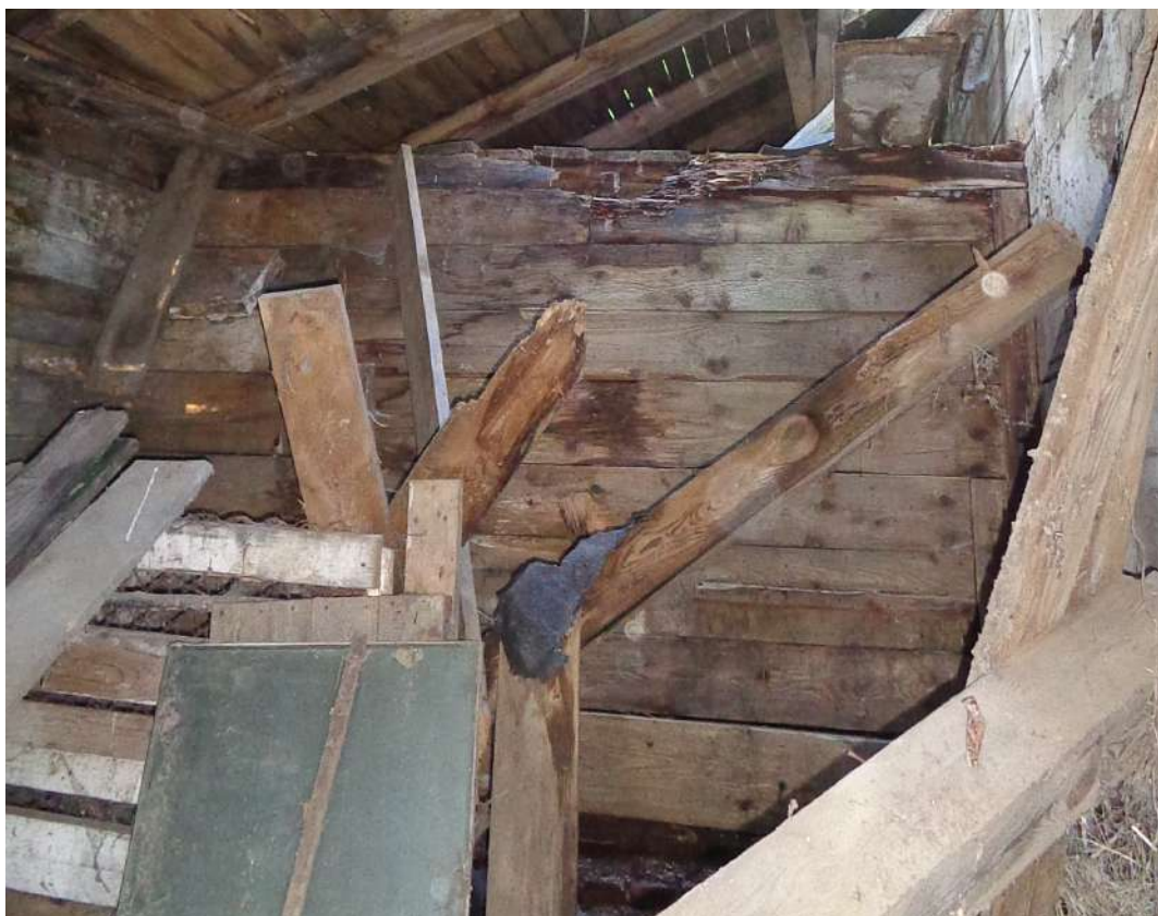
II.44. Budynek Gajówki w Parku Morysińskim, ocena stanu zachowania ścian wewnętrznych, widok na ścianę działową przybudówki, fot. A. Maślak, sierpień 2023
