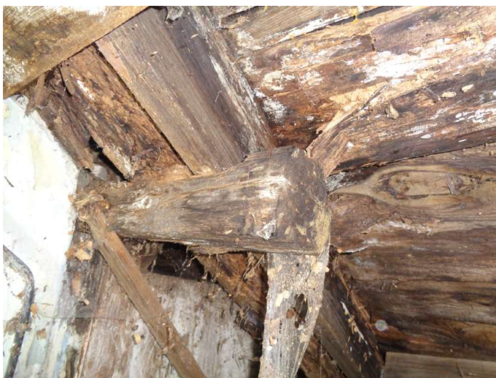
II.53. Budynek Gajówki w Parku Morysińskim, ocena stanu zachowania więźby dachowej, poddasze, widok na krokwie po stronie północno-wschodniej, fot. A. Maślak, sierpień 2023
