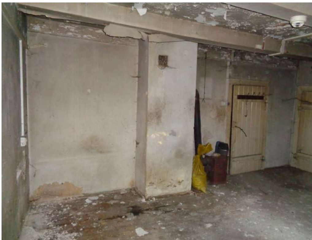
II.42. Budynek Gajówki w Parku Morysińskim, ocena stanu zachowania ścian wewnętrznych, widok na ścianę F, fot. A. Maślak, sierpień 2023
