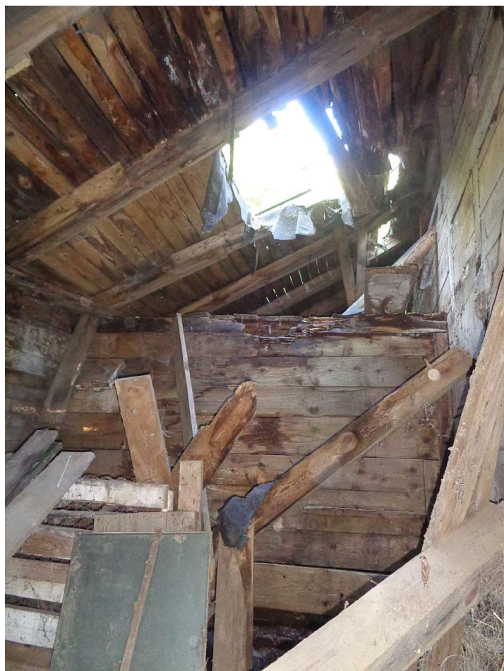
II.50. Budynek Gajówki w Parku Morysińskim, ocena stanu zachowania więźby dachowej, widok na krokwie po stronie północno-wschodniej, fot. A. Maślak, sierpień 2023
