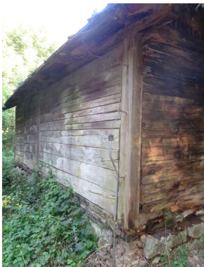
II.22. Budynek Gajówki w Parku Morysińskim, ocena stanu zachowania ścian obwodowych – ściana I, widok od zewnątrz, widoczne zawilgocenie ściany i zły stan podwaliny, fot. A. Maślak, sierpień 2023
