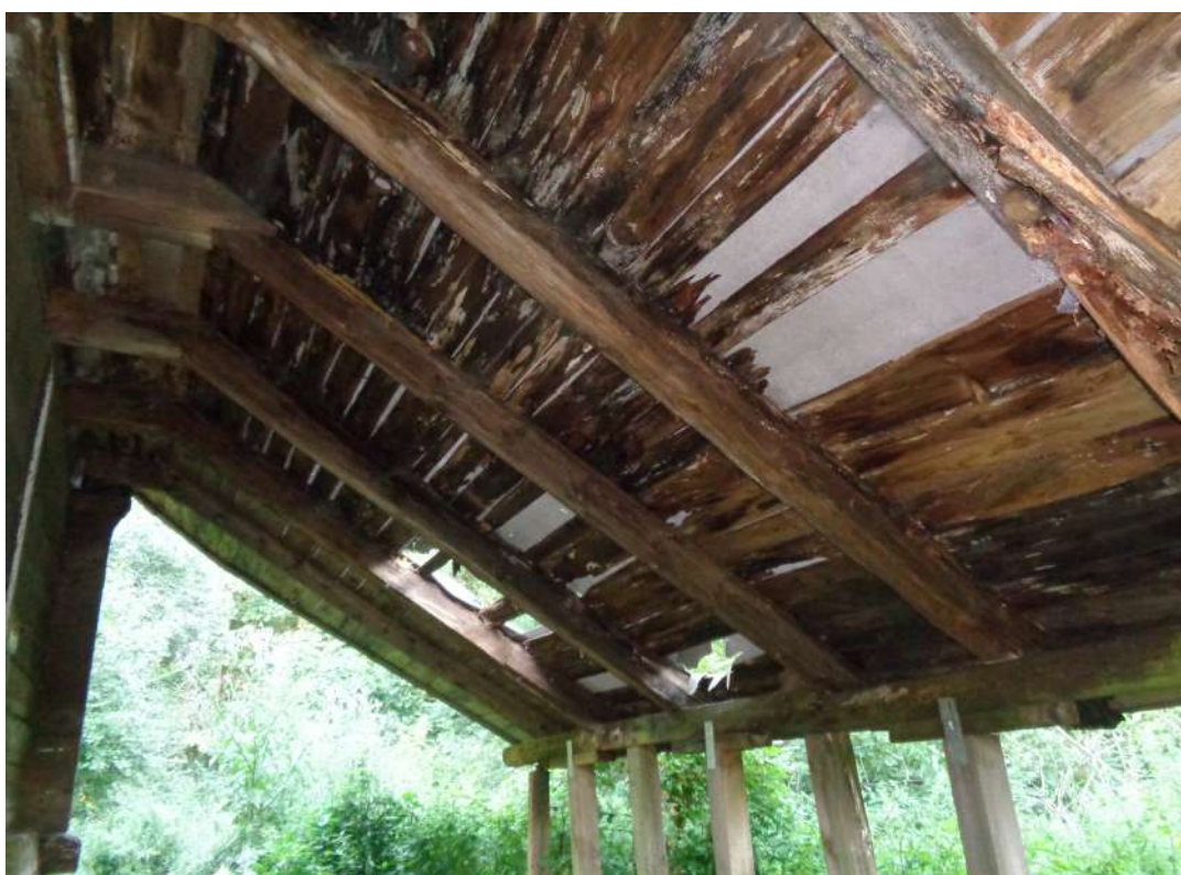
II.45. Budynek Gajówki w Parku Morysińskim, ocena stanu zachowania więźby dachowej, widok na krokwie po stronie południowo-zachodniej, fot. A. Maślak, sierpień 2023
