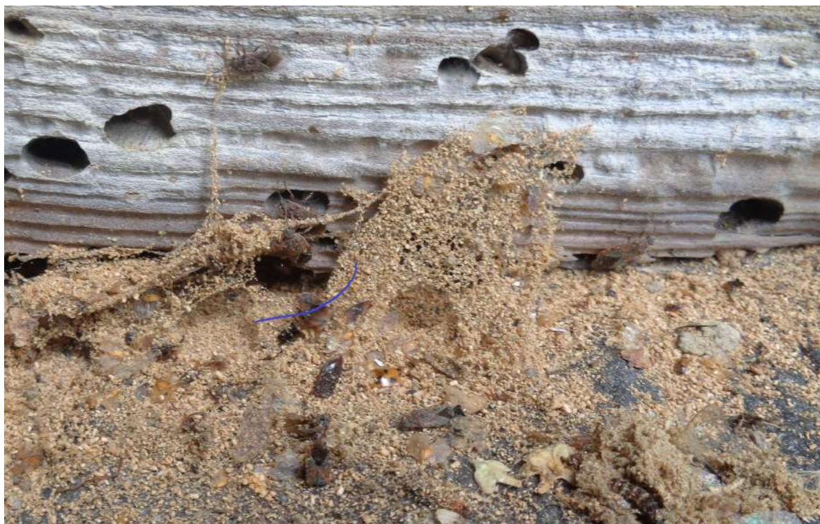
II.17. Budynek Gajówki w Parku Morysińskim, ocena stanu zachowania ścian obwodowych – ściana A, fragment ściany zasłonięty papą, kolonia wnyka amerykańskiego, fot. A. Maślak, sierpień 2023
