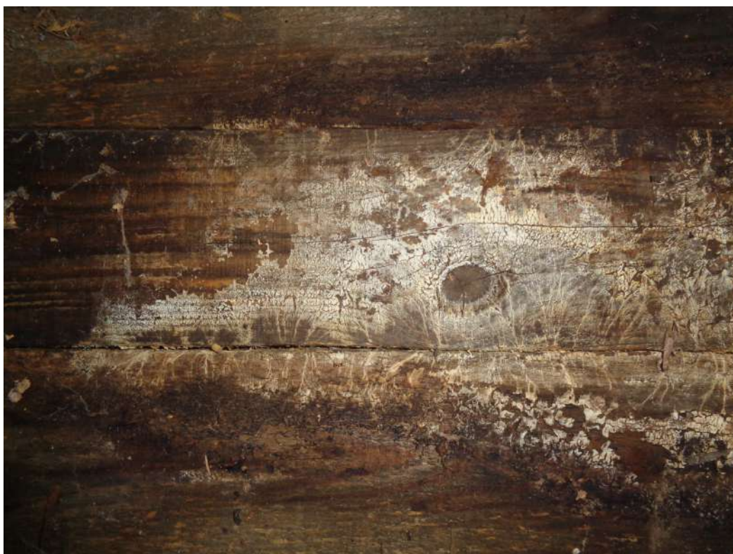
II.20. Budynek Gajówki w Parku Morysińskim, ocena stanu zachowania ścian obwodowych – ściana H, widok od zewnątrz, grzyb domowy biały, fot. A. Maślak, sierpień 2023
