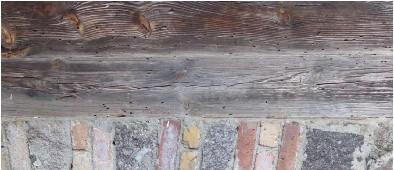
II.11. Budynek Gajówki w Parku Morysińskim, ocena stanu zachowania ścian obwodowych, widoczne ślady żerowania technicznych szkodników drewna, strona północno-zachodnia – ściana A, fot. A. Maślak, sierpień 2023
