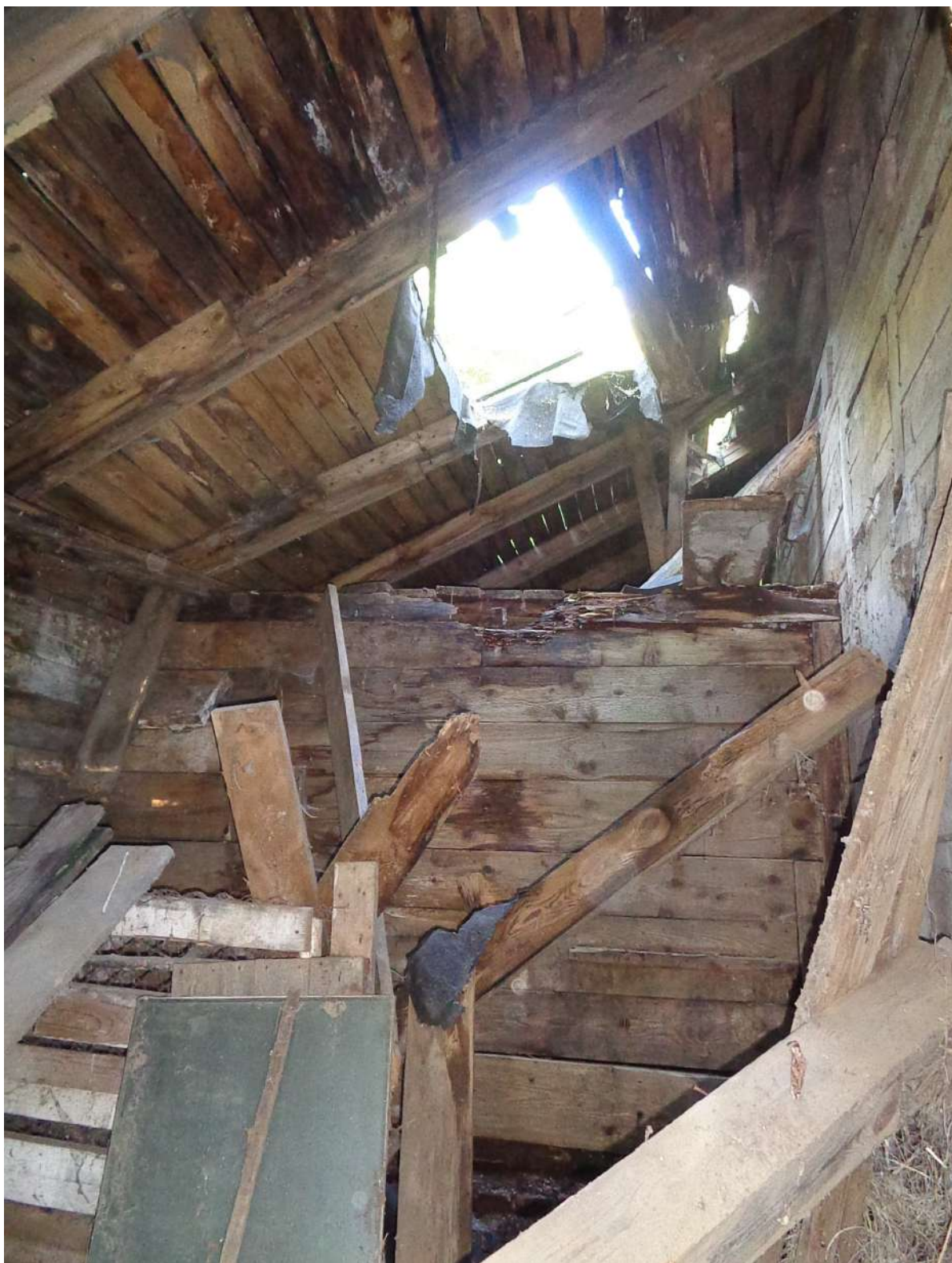
II.39. Budynek Gajówki w Parku Morysińskim, ocena stanu zachowania stropu w pomieszczeniu gospodarczym - w przybudówce, fot. A. Maślak, sierpień 2023
