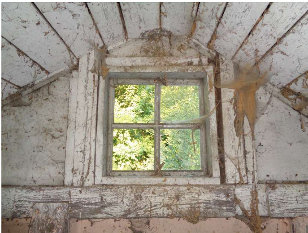
II.29. Budynek Gajówki w Parku Morysińskim, ocena stanu zachowania stolarki okiennej, okno na poddaszu, fot. A. Maślak, sierpień 2023
