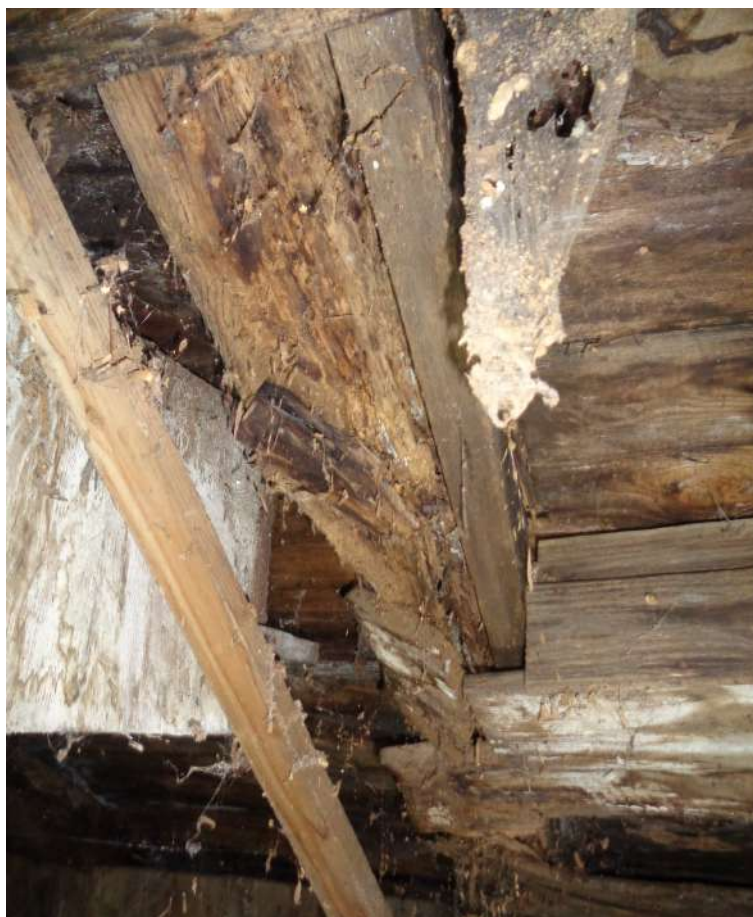
II.52. Budynek Gajówki w Parku Morysińskim, ocena stanu zachowania więźby dachowej, poddasze, widok na krokwie po stronie północno-wschodniej, fot. A. Maślak, sierpień 2023
