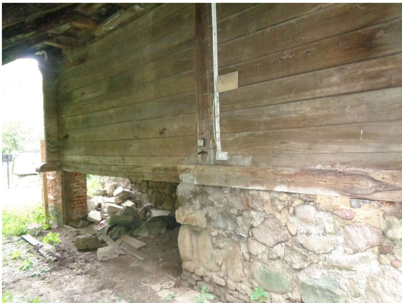
II. 2. Budynek Gajówki w Parku Morysińskim, ocena stanu zachowania fundamentu, widoczne uzupełnienia ubytków zaprawą cementową, ściana A, fot. A. Maślak, sierpień 2023
