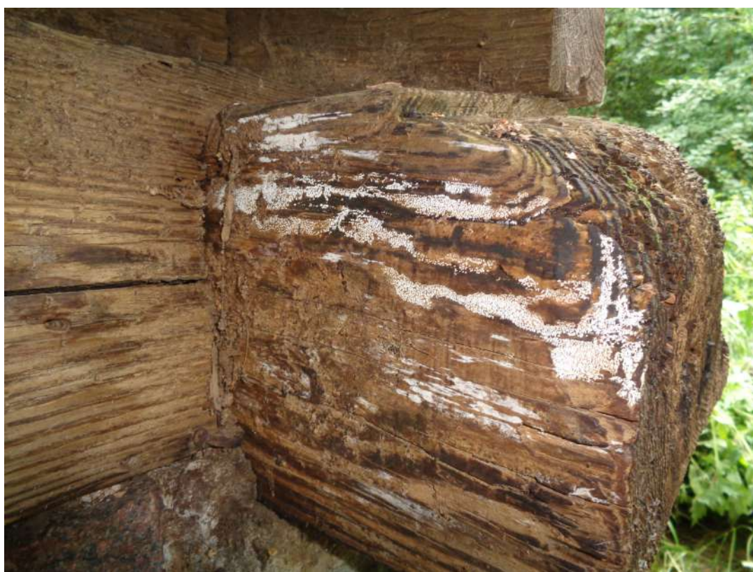
II.10. Budynek Gajówki w Parku Morysińskim, ocena stanu zachowania ścian obwodowych, widoczne ślady grzyba domowego białego, strona południowo-zachodnia – ściana D, fot. A. Maślak, sierpień 2023
