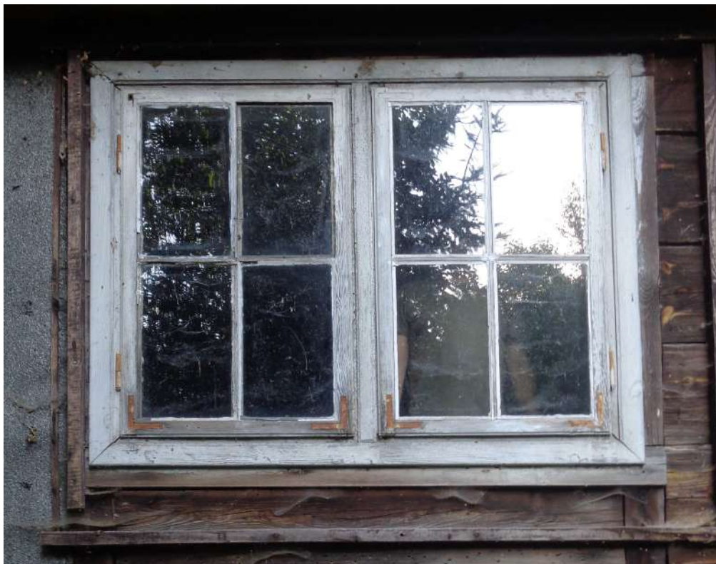
II.26. Budynek Gajówki w Parku Morysińskim, ocena stanu zachowania stolarki okiennej, okno izby w przyziemiu, fot. A. Maślak, sierpień 2023
