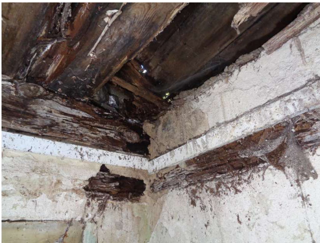
Il.37. Budynek Gajówki w Parku Morysińskim, ocena stanu zachowania stropu w pomieszczeniu kuchni, widoczny rozległy rozkład brunatny drewna, fot. A. Maślak, sierpień 2023
