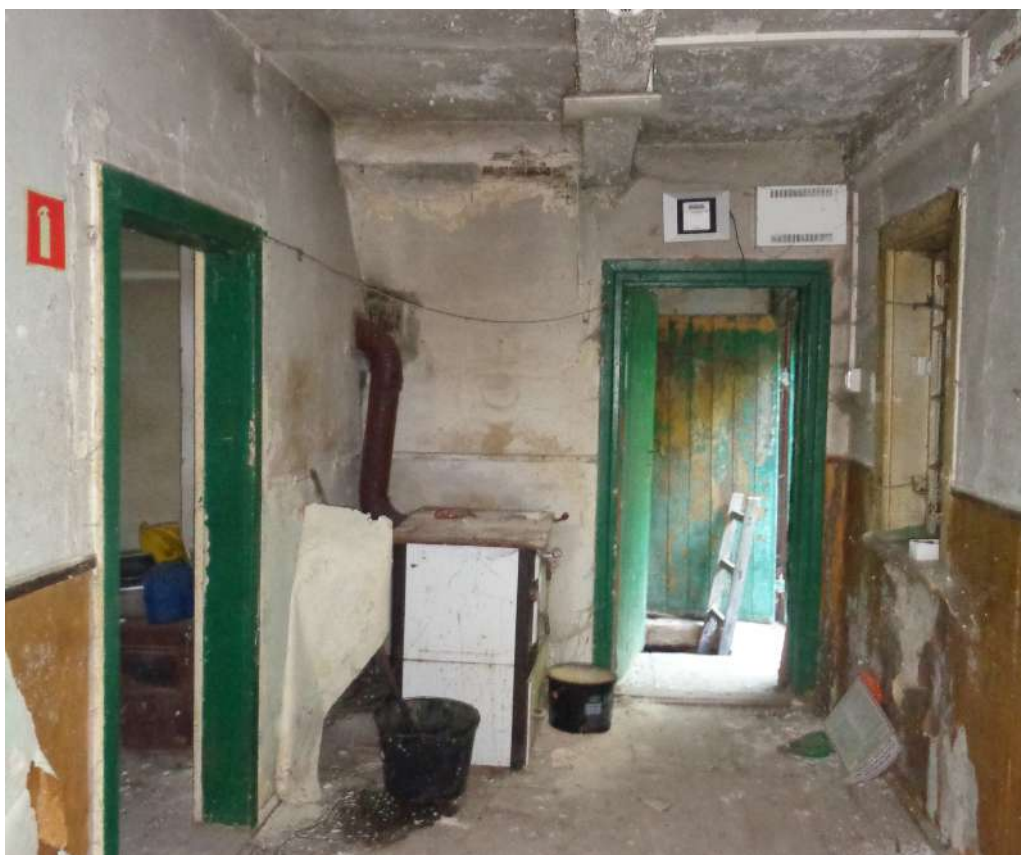
II.43. Budynek Gajówki w Parku Morysińskim, ocena stanu zachowania ścian wewnętrznych, widok na ścianę G, fot. A. Maślak, sierpień 2023
