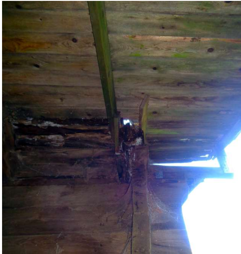
II.47. Budynek Gajówki w Parku Morysińskim, ocena stanu zachowania więźby dachowej, widok na krokwie po stronie południowo-zachodniej, fot. A. Maślak, sierpień 2023
