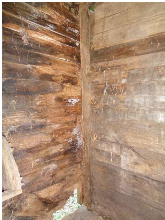
II.18. Budynek Gajówki w Parku Morysińskim, ocena stanu zachowania ścian obwodowych – ściana H, widok od wnętrza, widoczne zawilgocenie i rozkład brunatny, fot. A. Maślak, sierpień 2023
