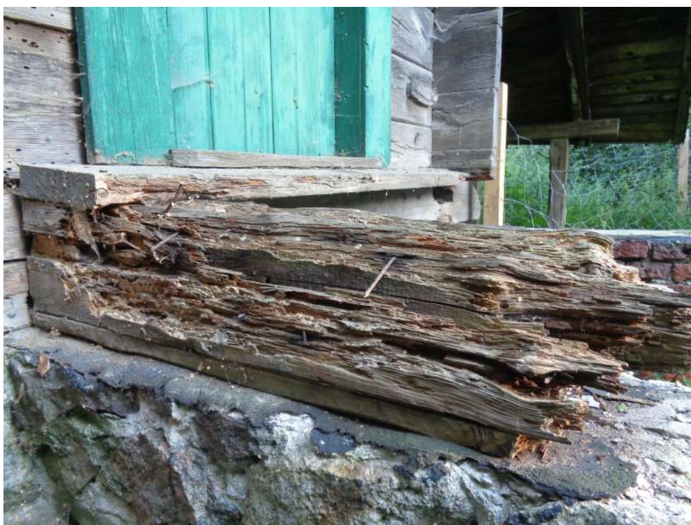
II.8. Budynek Gajówki w Parku Morysińskim, ocena stanu zachowania ścian obwodowych, widoczna destrukcja podwalin, strona północno-zachodnia, fot. A. Maślak, sierpień 2023
