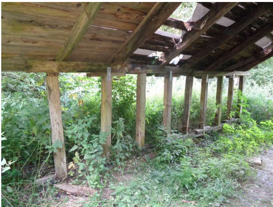
II.5. Budynek Gajówki w Parku Morysińskim, ocena stanu zachowania pokrycia dachowego, widoczne ubytki w pokryciu dachowym, strona południowo-zachodnia, fot. A. Maślak, sierpień 2023
