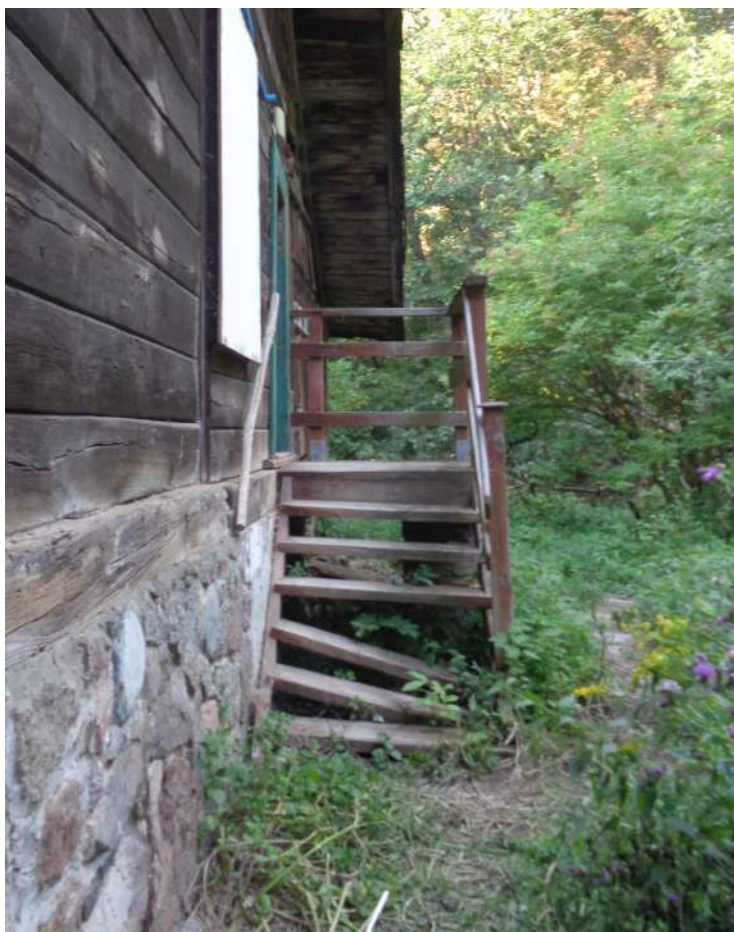
II.54. Budynek Gajówki w Parku Morysińskim, ocena stanu zachowania, schody po stronie południowo-wschodniej, fot. A. Maślak, sierpień 2023
