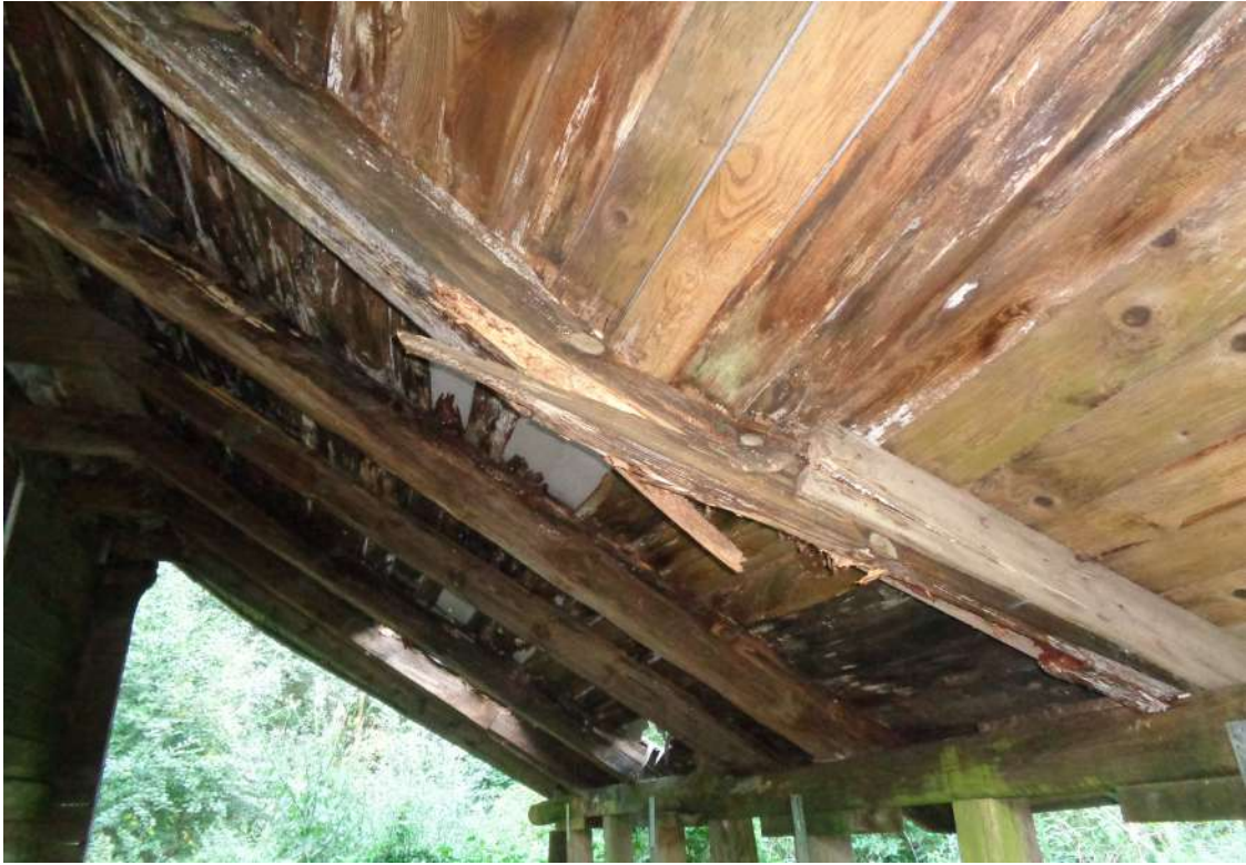
II.46. Budynek Gajówki w Parku Morysińskim, ocena stanu zachowania więźby dachowej, widok na krokwie po stronie południowo-zachodniej, fot. A. Maślak, sierpień 2023
