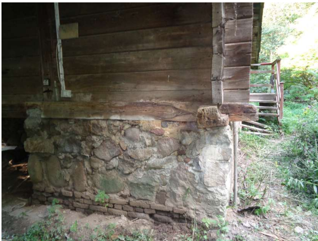
II.9. Budynek Gajówki w Parku Morysińskim, ocena stanu zachowania ścian obwodowych, widoczne ślady pleśni, strona południowo-zachodnia – ściana D, fot. A. Maślak, sierpień 2023
