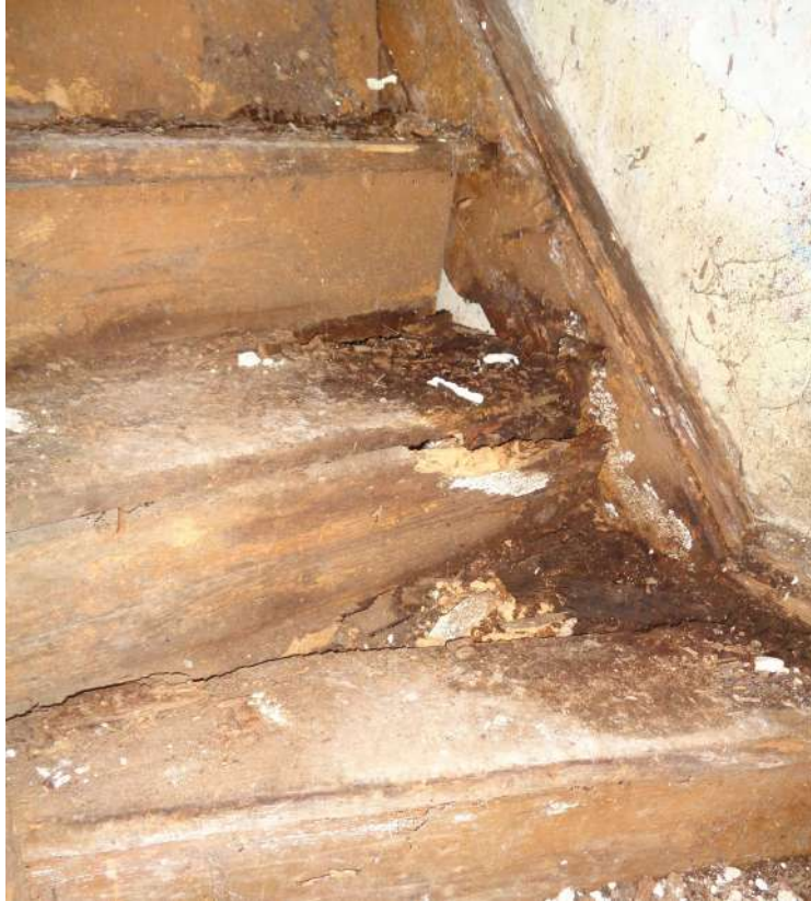
II.56. Budynek Gajówki w Parku Morysińskim, ocena stanu zachowania, schody wewnętrzne, fot. A. Maślak, sierpień 2023
